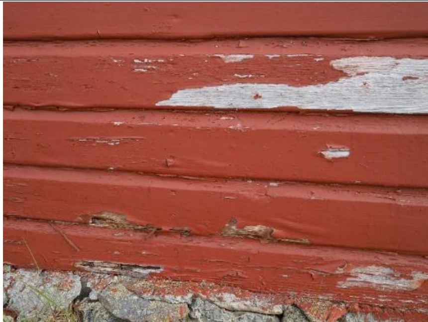
Bilde 1. og 2. Viser noe av forfallet på hytta, med avflasket maling og råte i bordkledning. Foto. Rolf Ims.
