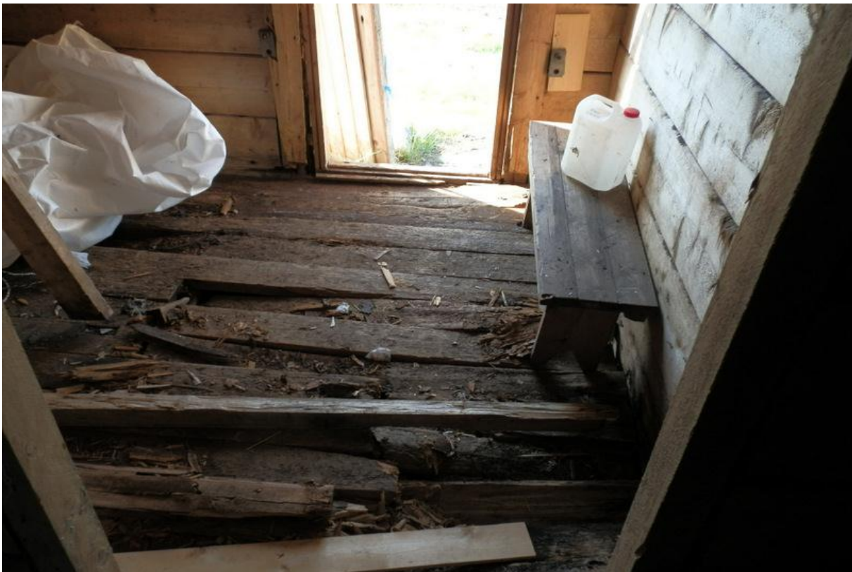
«stallen» i Ragnarokhytta er helt falleferdig og døra må skiftes ut
