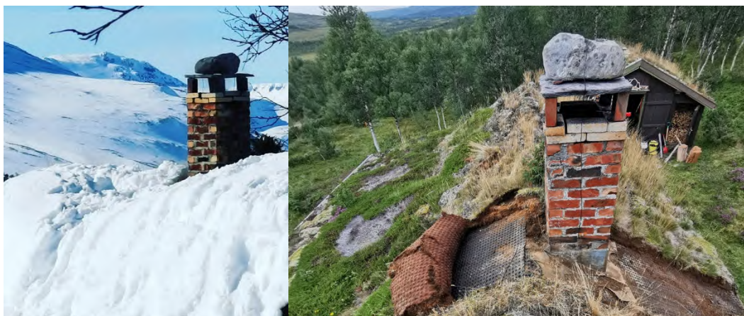
Den gamle pipen på fritidsbolig gnr/bnr. 151/19 i Jøldalen før arbeidet sommeren 2025.
