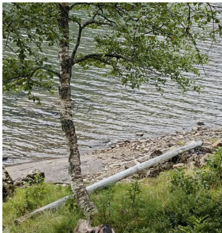
Stolpe ved vannkant langs Innerdalsvegen. Tatt 12.08.2025.
