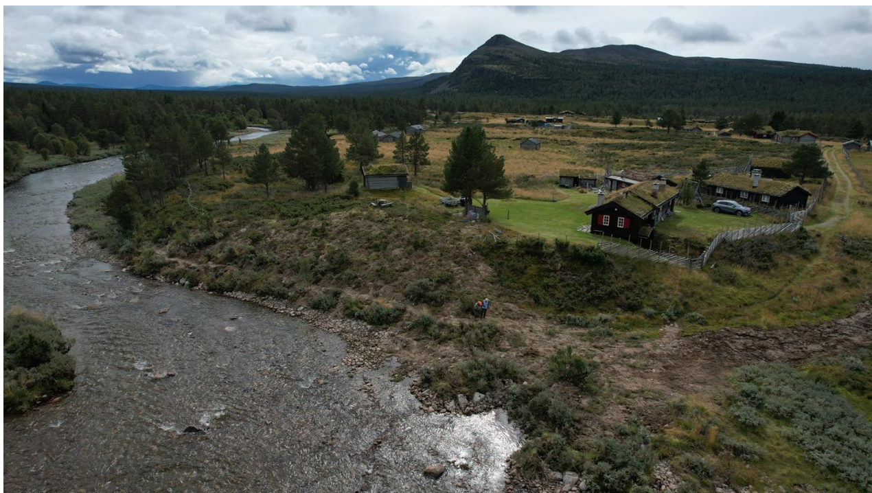
Bilde 22: Erosjonssikring i Misterdalen.
