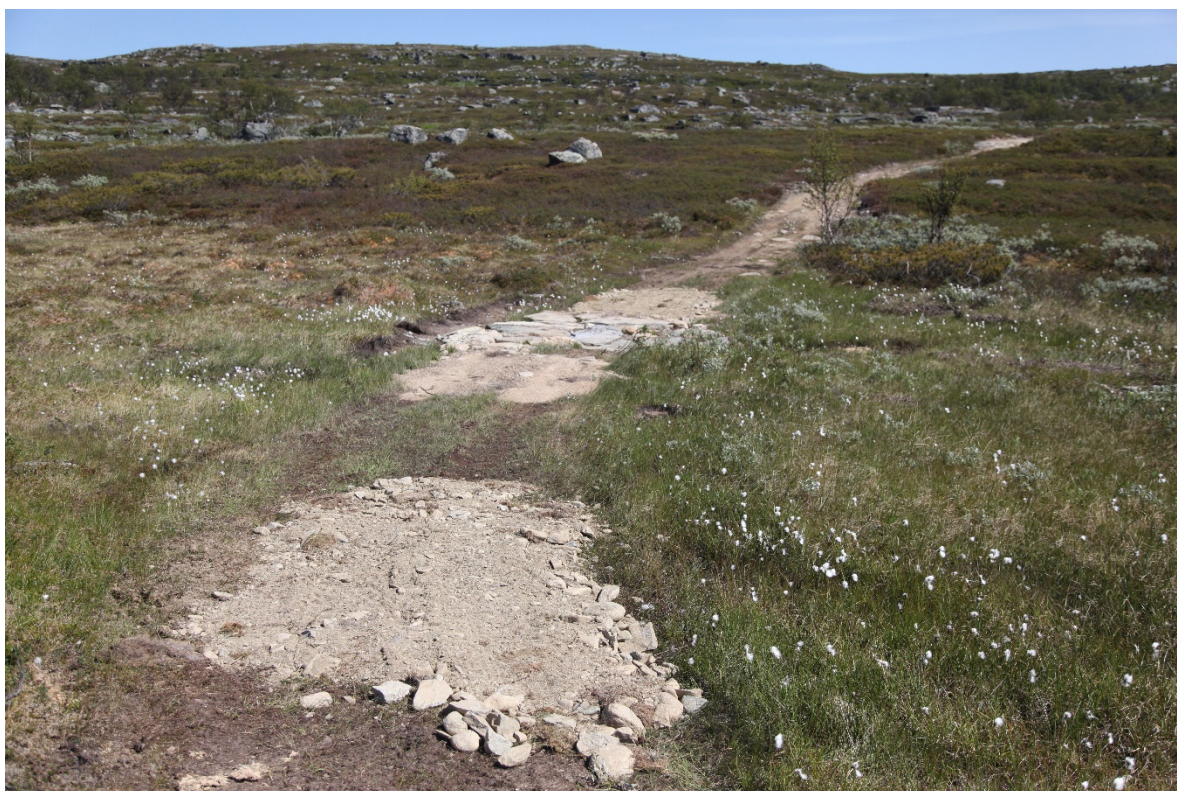
Figur 5.2. Kjørevegen fra Gruvsjøen mot Hyddkroken. Vedlikehold av vegen pågikk.
