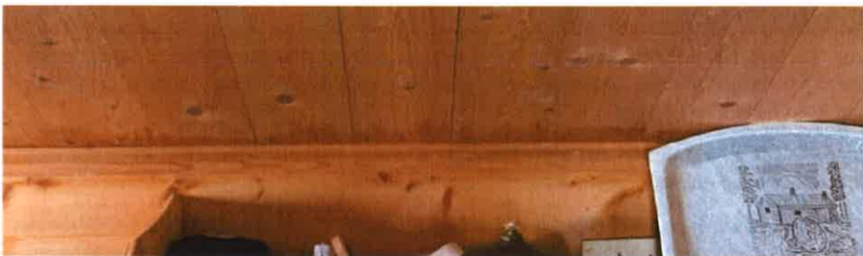
Fuktskader over hylle.
