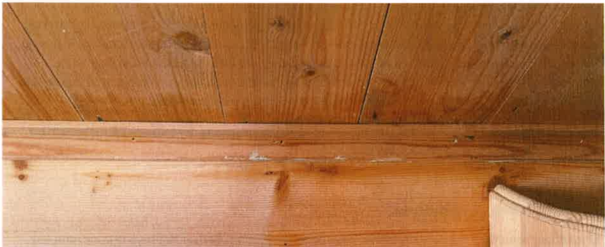
Fuktskade ute ved raft langs langvegg mot sør fra fuktig luft som kondenseres.
