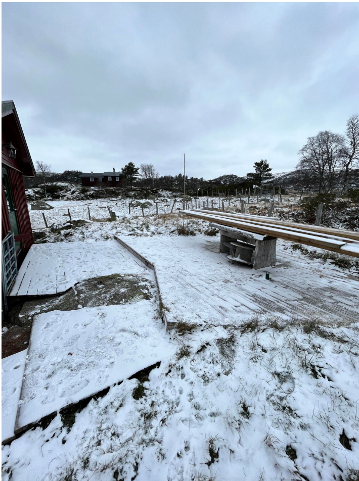
Figur 6: Frittstående plattung på nordsiden. Areal målt til 19,2 m 2 . Denne delen kreves fjernet.
