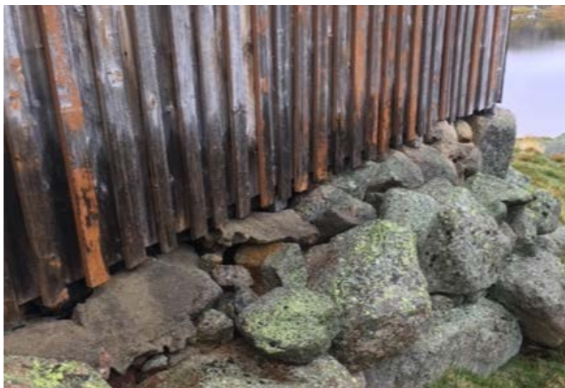
Råteskadar må utbetrast
