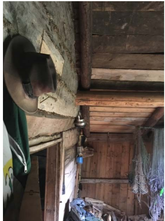
Gavlen mot aust er i ferd med å bryte saman., Stavlægje må bytast ut/forsterkast.
