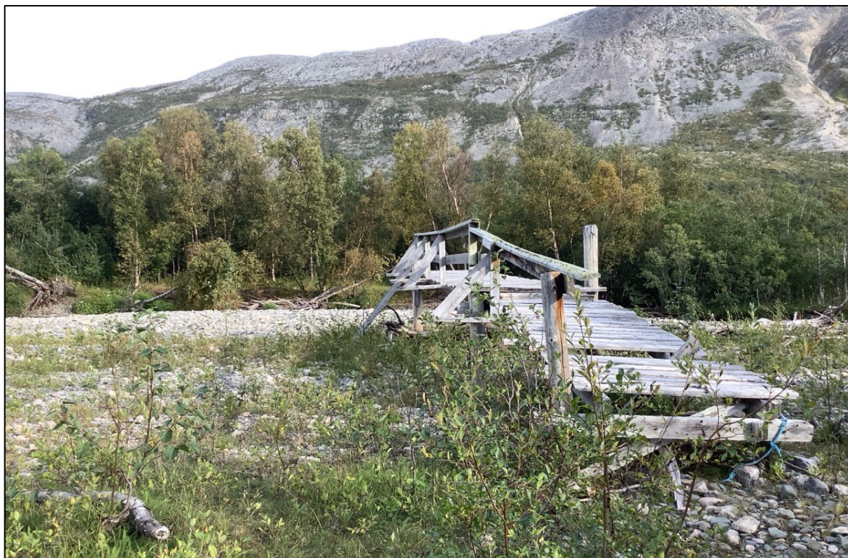
Figur 28. Kollapset gammel bru på åpen elveør.
