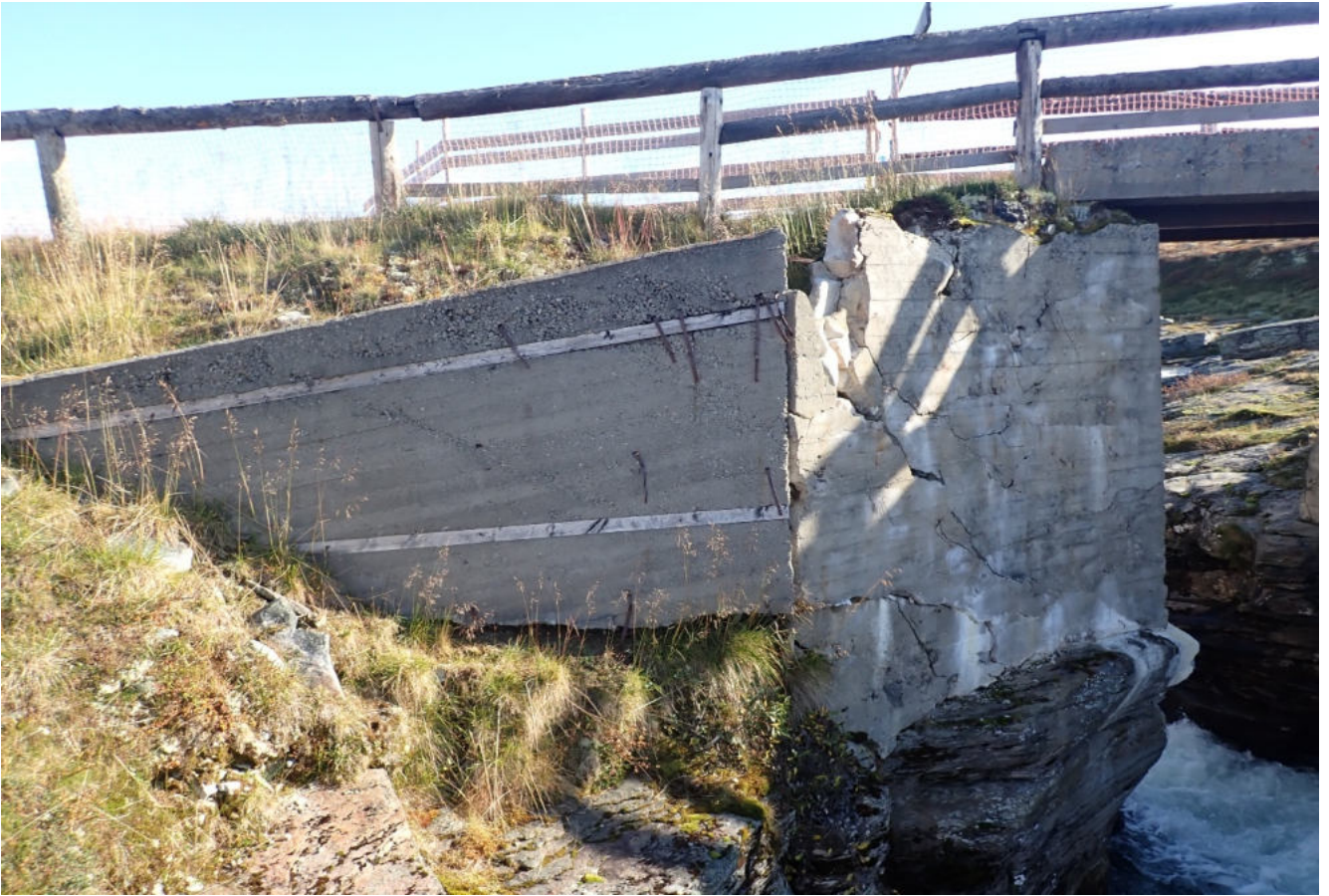
A7 – Landkar nord og nedstrøms vinge, manglende fundamentering vs, oppsprekking og brudd hs
