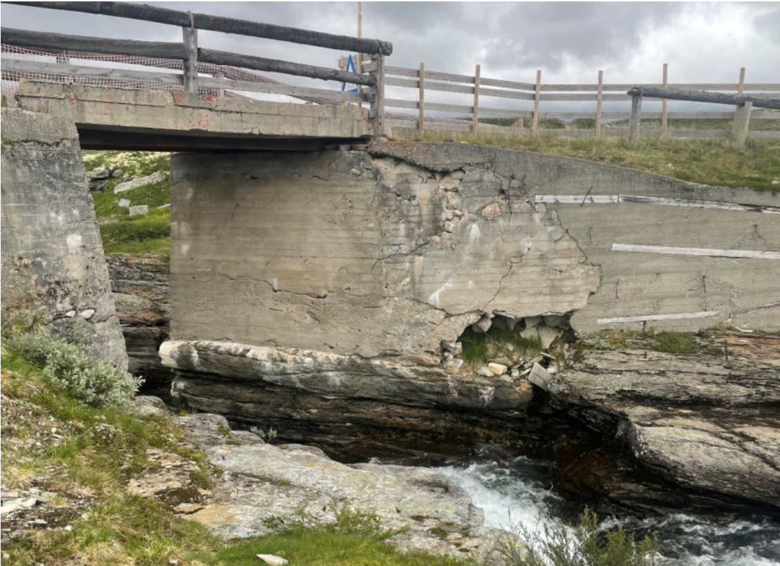
B2 – Landkar nord med stort hull uk oppstrøms vinge
