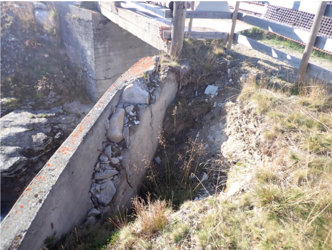
A6 – Landkar nord og oppstrøms vinge, vannerosjon innenfor vinge
