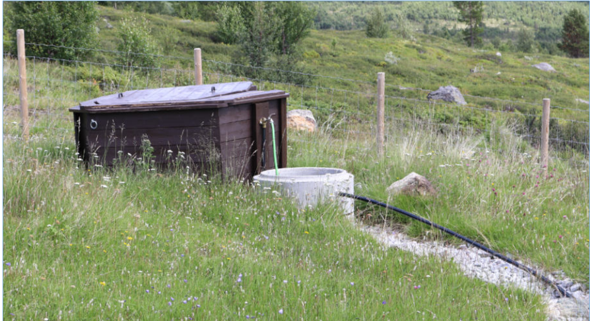
Figur 17. Utendørs dusjanlegg og overløpskum.
