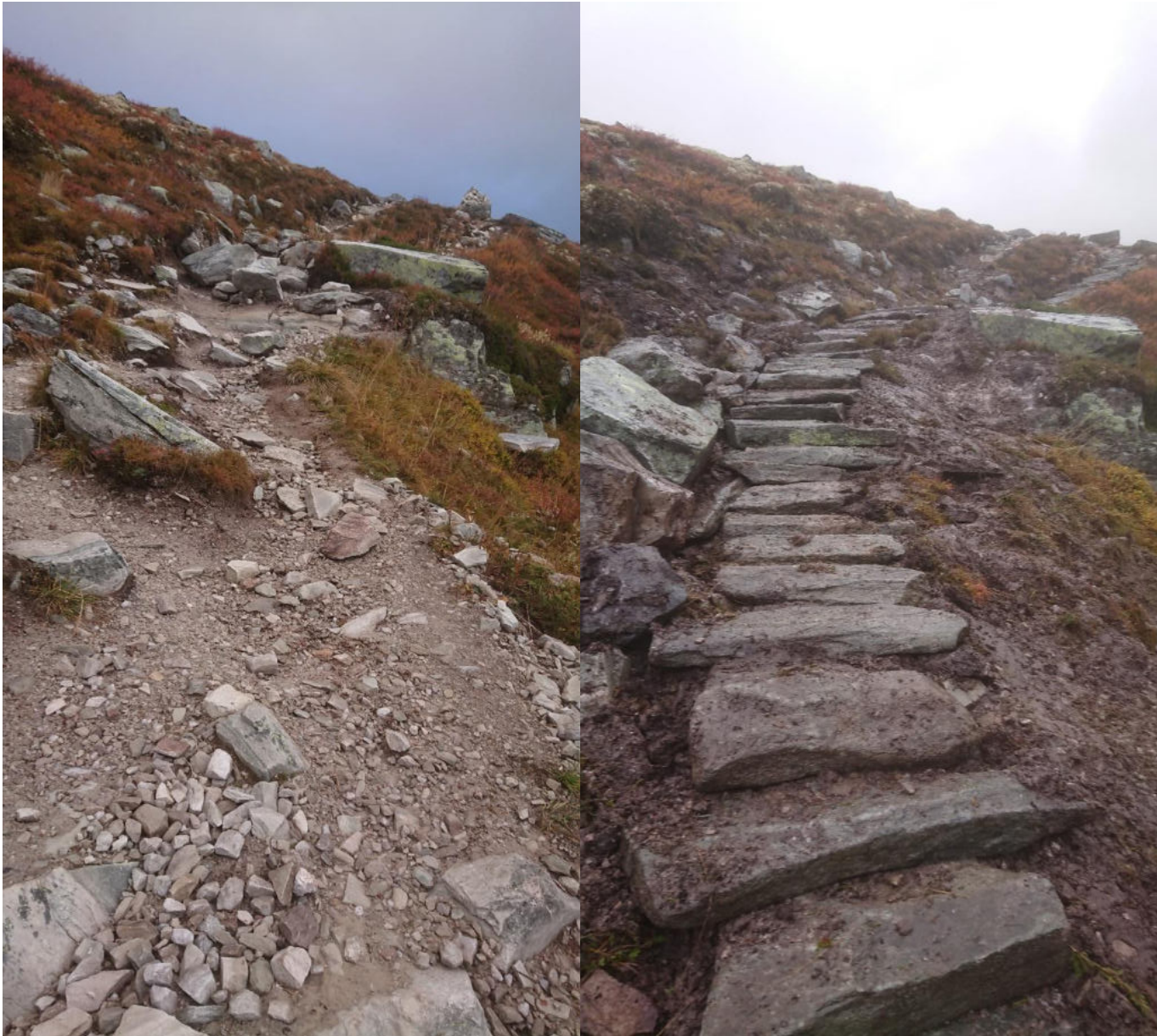
Erosjonsutsatt skråning før og etter.
