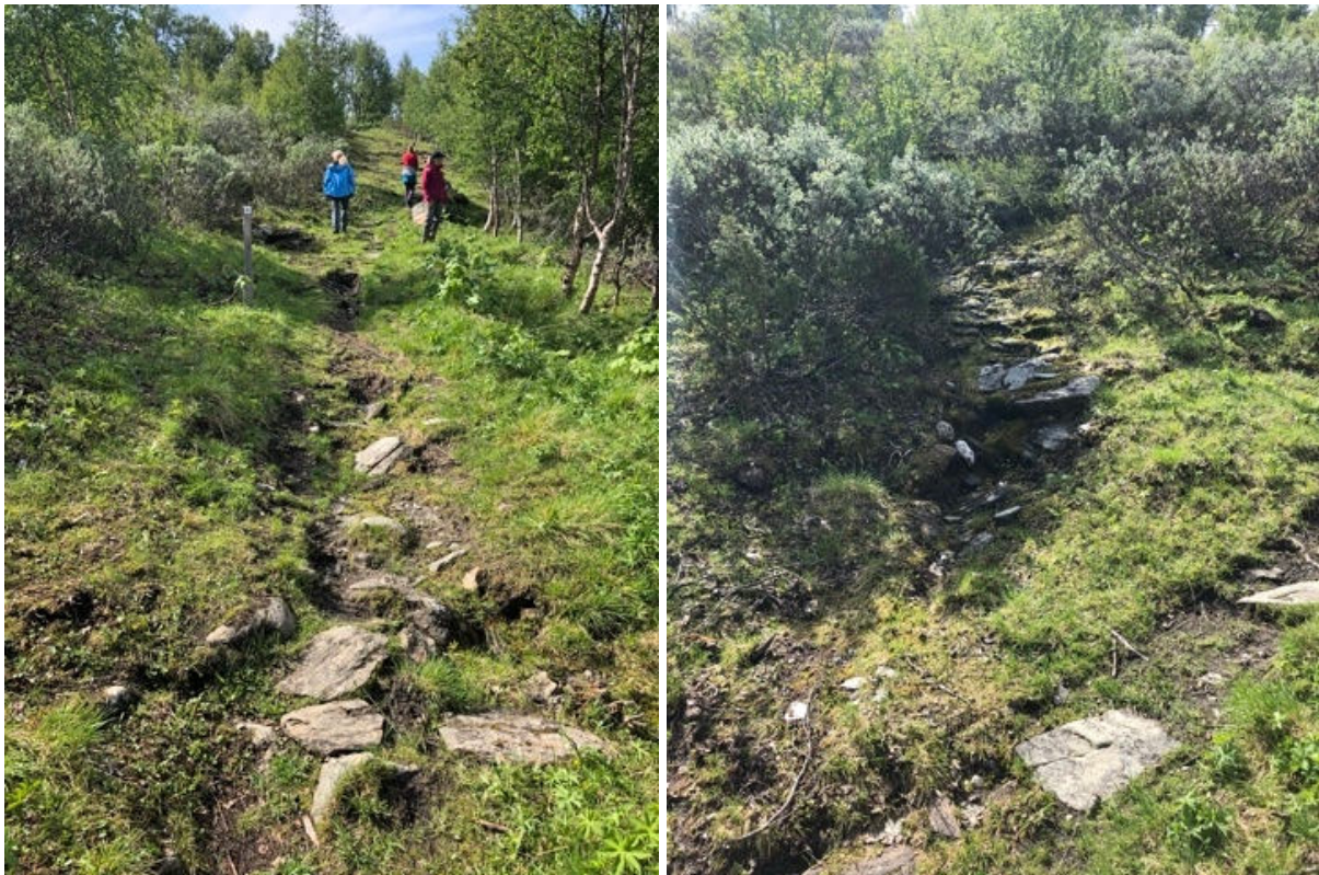
Bilder av tiltaksområde 4 som tydelig viser hvordan vannmasser har gravd ut deler av veglegemet. Foto: IFK/Øystein R. Andersen
