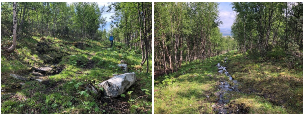
Bilder av tiltaksområde 3 der rennende vann trekker ut i vegen og forårsaker vannskader i form av store og dype renner i veglegemet. Foto: IFK/Øystein R. Andersen
