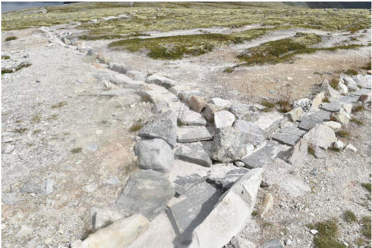
Figur 35. Det er murt opp grøfter for å lede vannet unna stien og de bratteste bakkene. Foto: Dagmar Hagen.
