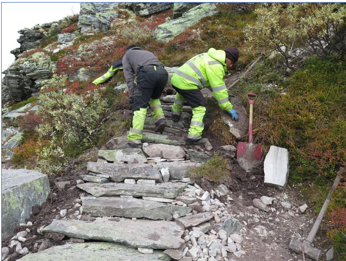
Sherpaer i arbeid på stien fra Rondvassbu til Rondeslottet. Foto: Finn Bjormyr (SNO).
