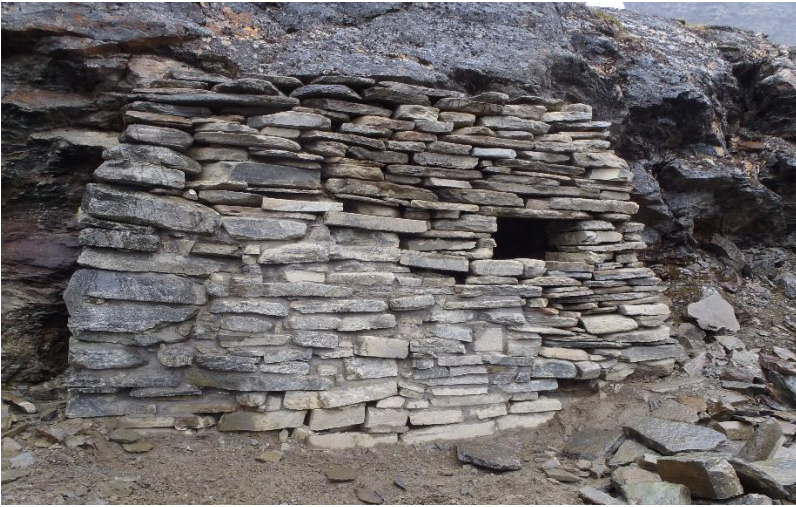
Figur 7: Hotell Hilton september 2019. Det gjenstår noe mindre arbeid før restaureringen er ferdig. Foto: Kjetil Letto, Statskog fjelltjenesten.
