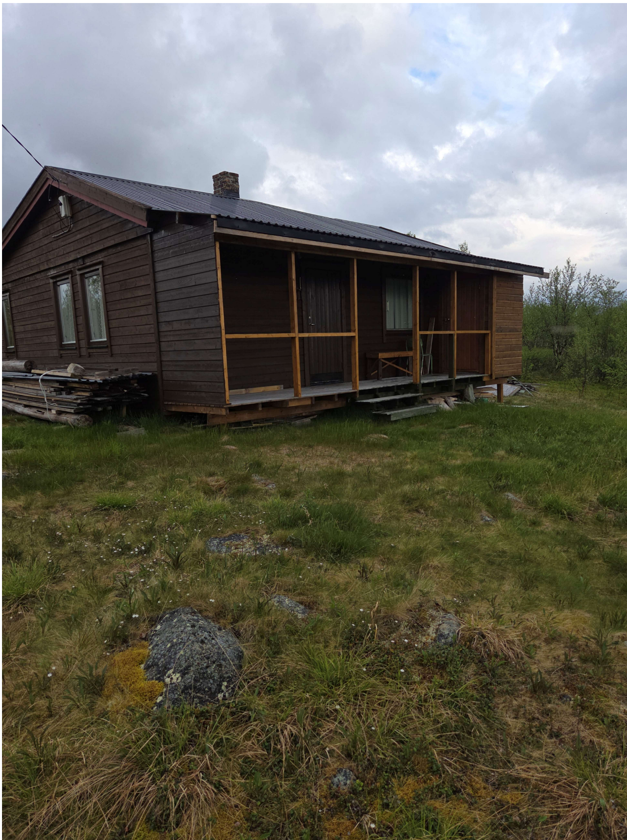
Figur 8: Bildet er tatt 02.07.25, mot sør og viser hyttens front og inngangsparti. På bildet kan man se at det er reist opp et takoverbygg over inngangen. På kortsiden av overbygget er det satt opp en vegg av liggende trepanel.
