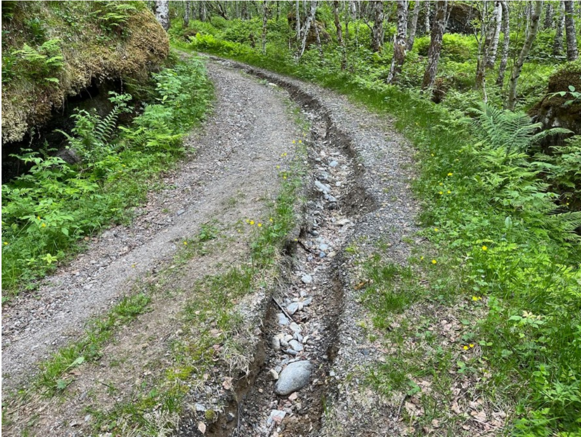
Figur 12 . Ved strekningspunkt 16 går stien over til skogsveg som her er preget av vannerosjon.
