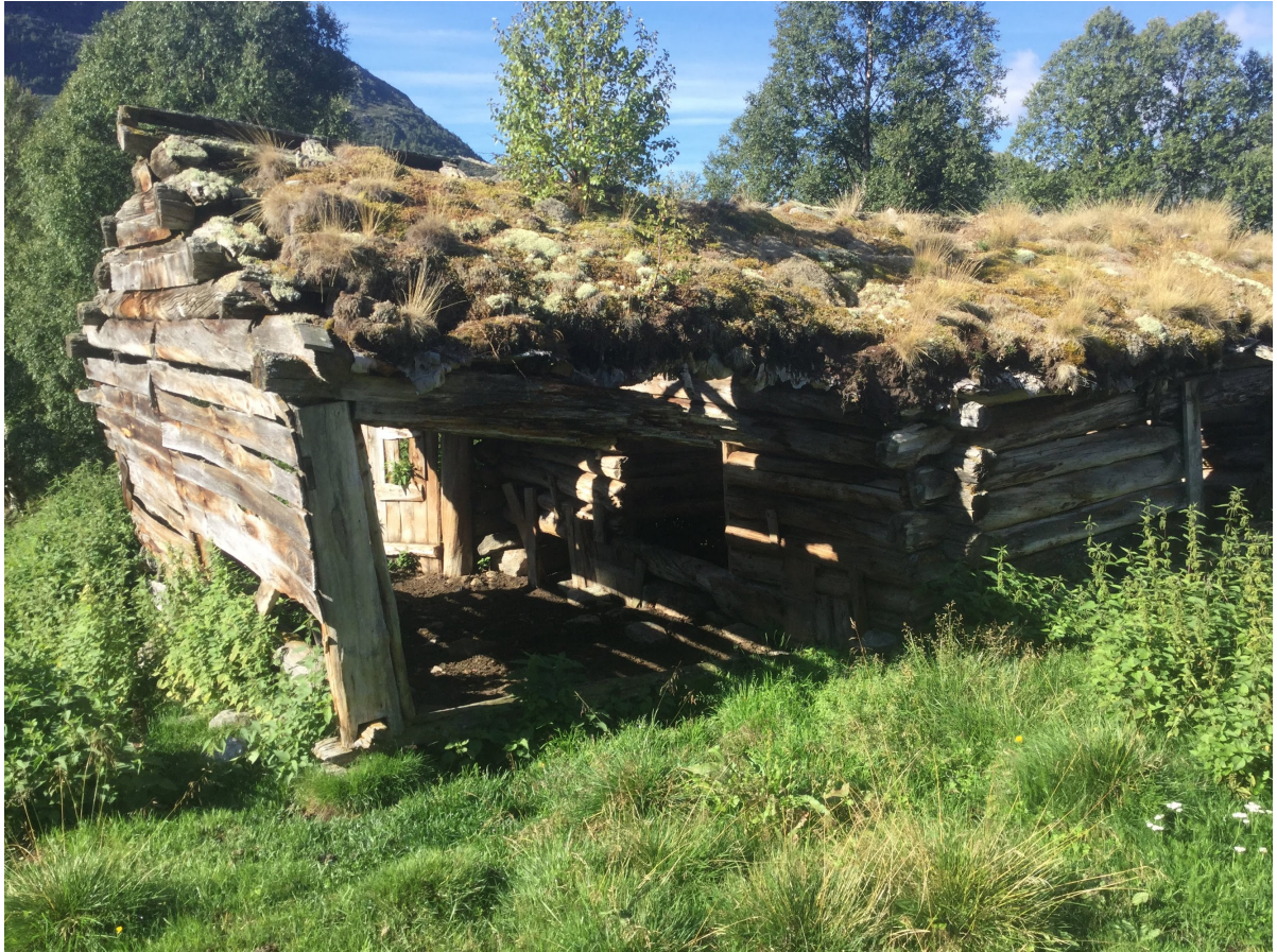
Figur 13. Fjøset på Gamlegarden er til nedfalls og forfallet er trolig kommet for langt til å reddes. Foto: Helge Fjeldstad.
