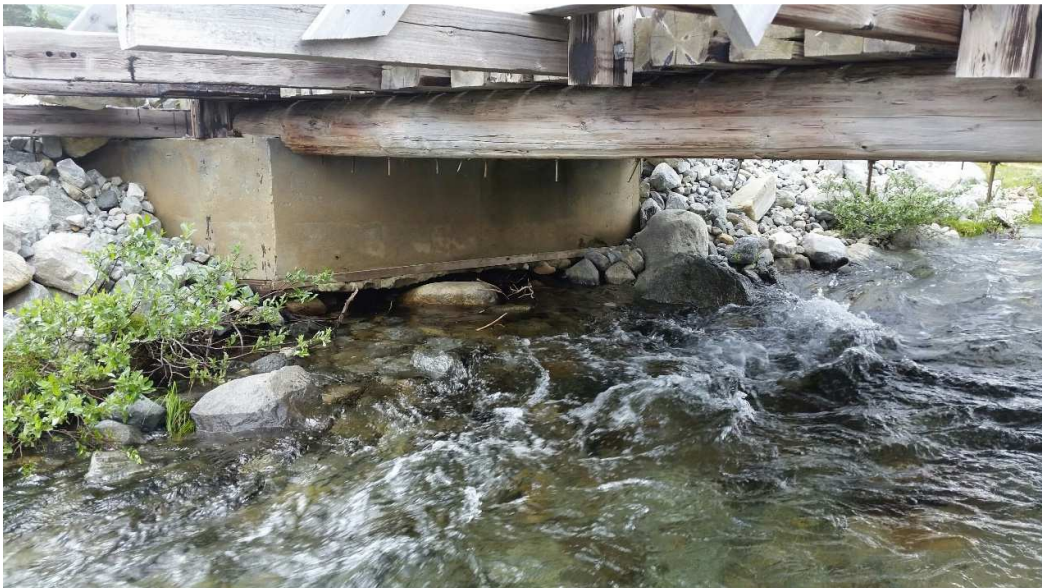
Brua der Finndalsvegen går over sideløpet. Den kraftig auka vassføringa har undergrave fundamenta på både sider. Utan tiltak vil brua reise i neste flaum.
