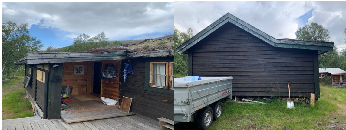
Foto viser inngangsparti frå sør, og tilbygg frå nord. Knekken på taket er eit svakt punkt, og fører til lekkasje.
