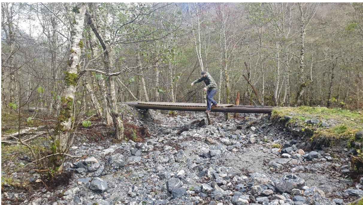
Figur 22: Klopp med erosjonsutsatte fundamenter.
