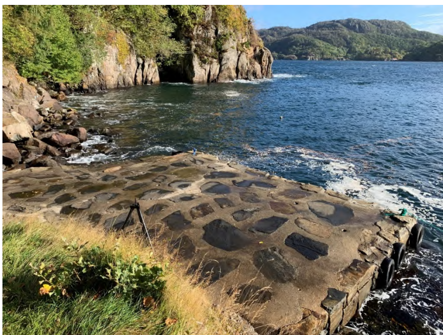
Figur 7 Brygge i Dåtlandstrand. I fjellveggen i bakgrunnen er det montert en sikringswire til Via ferrata. Foto: Rambøll.
