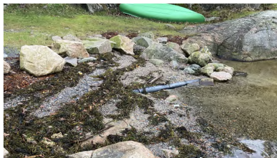
Bilde som viser blottlagt ledning.
