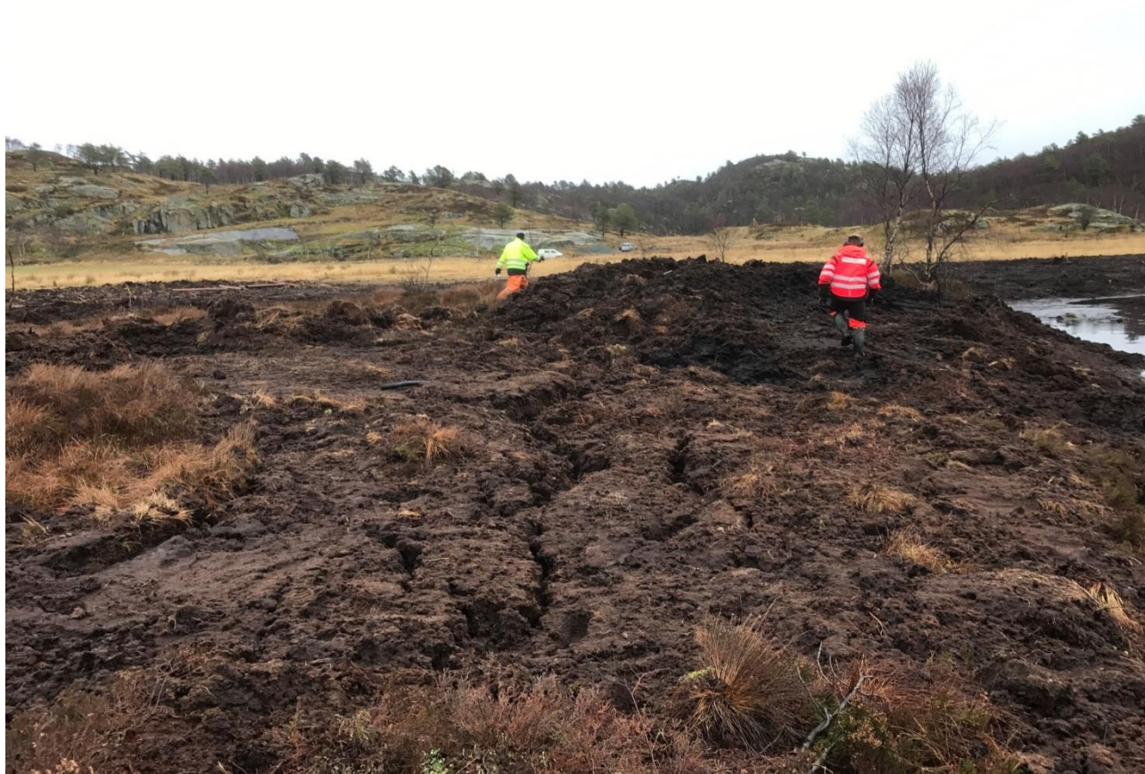
Figur 3. Massene siger og sprekker. Det nødvendiggjorde planendringer, ekstraarbeider og at tiltak må slutføres i 2017.
