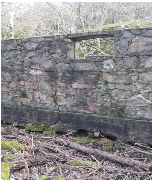
Figur 7. Nordre kortvegg på kjøkkenbrakken som viser utvasking under grunnmuren og setningsskader.
