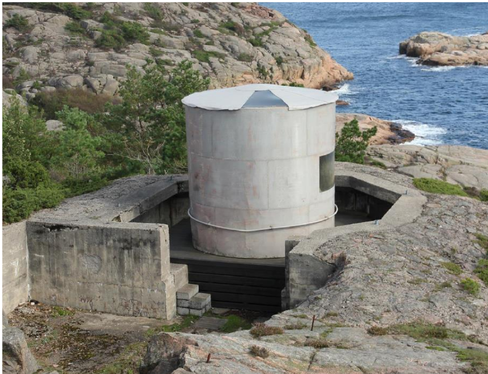
Figur 13. Overbygget til lyskasteren som trenger rehabilitering.
