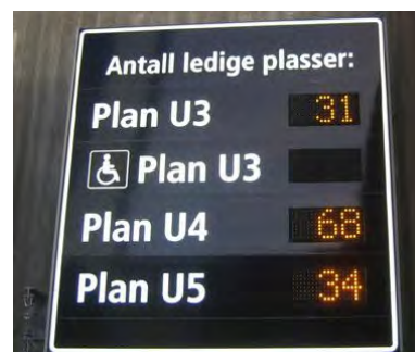
Figur 17 Eksempel på parkeringsinformasjonstavle.
