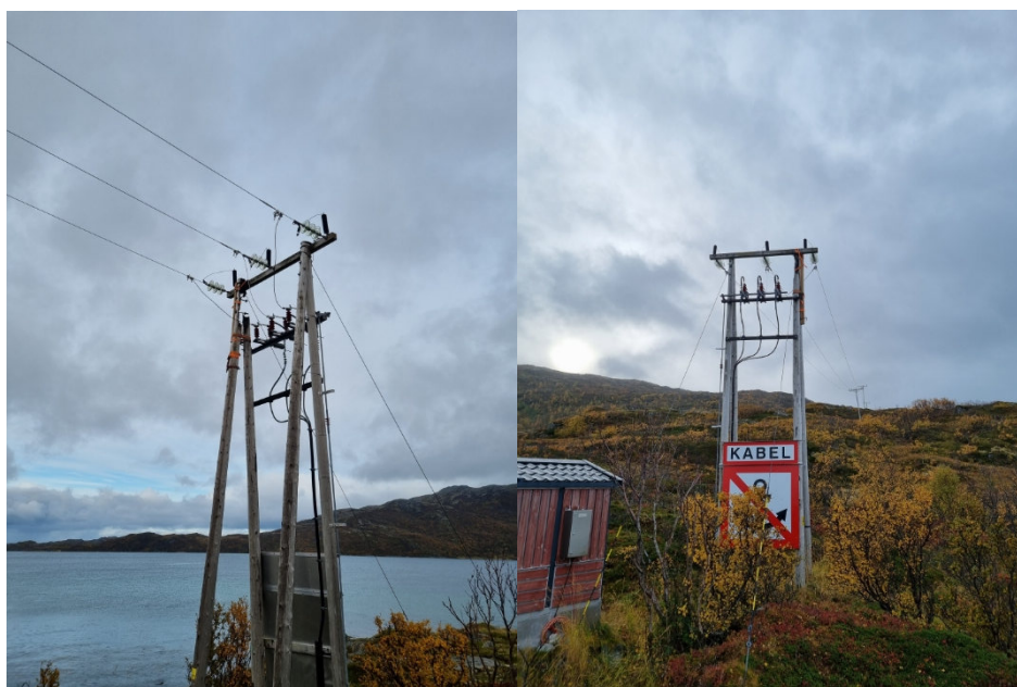
Bilde 2 og 3: bilde av skadet stolpe.
