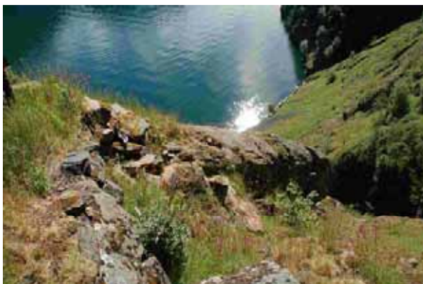
Figur 13 Ras slår ut muren. Kritisk punkt i sving rett over Kolda.
