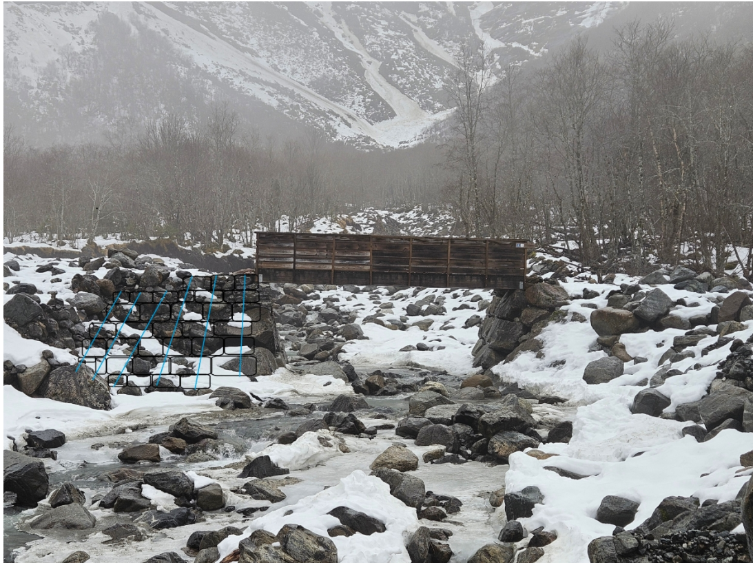
Figur 3: Forslag fra entreprenør til reparasjon av brukar. Mur og kamstag nedstrøms fra brua.
