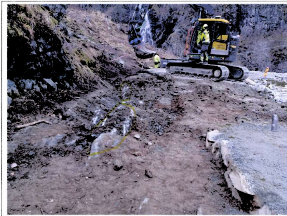
Bilde 2. Bergknauser markert med gult må fjernes for å skape fall, så grøfta kan forlenges og vannet ledes ut i sideterrenget i overkant av steinrøysa på bilde 1.
