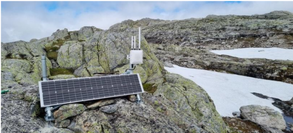
Bilde av basestasjon. Kopi frå søknad
