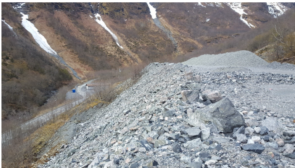
Deponerte massar på fyllinga ved Gudvangatunnelen. Kopi av bilde i brev frå Aurland kommune. Bildet er tatt 06.05.2021.
