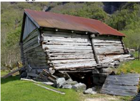
Lóa/tobakkshuset på bnr. 2. Bygningen er av lafta rundtømmer frå midten av 1800-talet. Den er viktig for heilskapen i tunet. Bygningen fekk store skader under stormen Dagmar i des. 2011.
