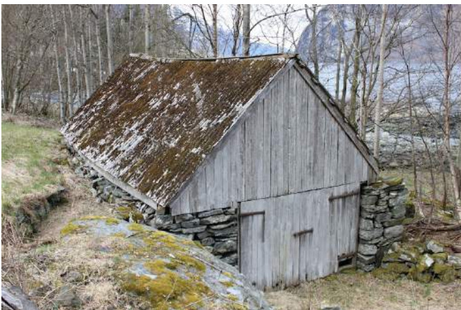
Gbnr. 50/2 Hjødlanaustet. Taket bør skiftast. Bakmuren treng oppretting.
