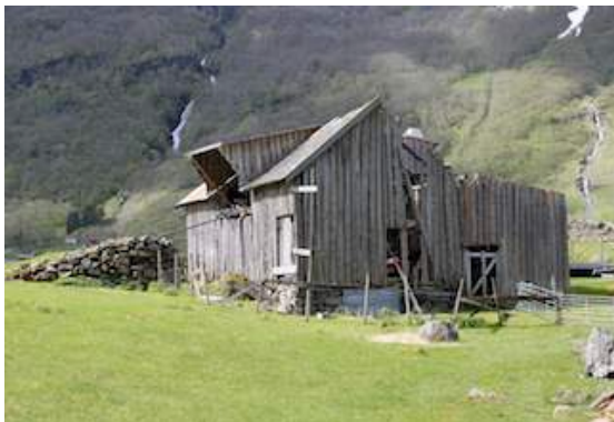
Sommarfjøs til gbnr. 58/1. Fekk store skader under stormen Dagmar i des. 2011.
