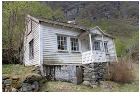
Gbnr. 64/22 Husmannsstove (1800-talet). Ein del forfall. Truleg naudsynt med strakstiltak.
