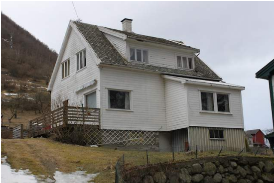
Gbnr. 51/91. Solhov. Bygt 1939. Bygt på tomte til tobakkshuset. Ligg innanfor spesialområdet, og er viktig for heilskapen. Treng utvendig vedlikehald.
