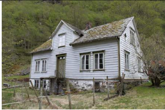
Våningshus på gbnr. 59/2 er eit fint døme på lokal byggjeskikk frå 1800-talet – klassisistisk/empirestil. Bygt av Anders Løne – som har bygt mange fine bygningar i Aurland. Bygningen har stått ubrukt i fleire år og har mykje forfall.
