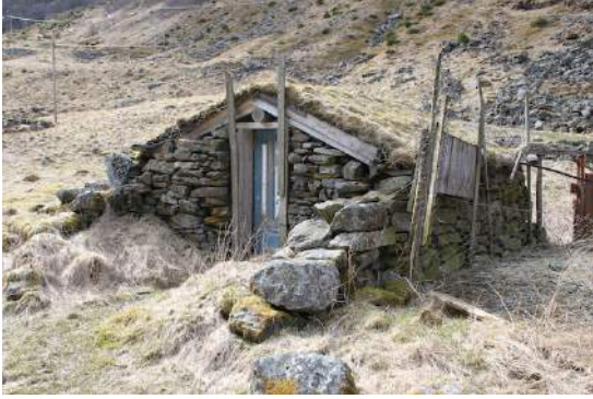
Mjølkebu til gbnr. 51/15. Sjelden variant oppført i naturstein og nedsenka i terrenget.
