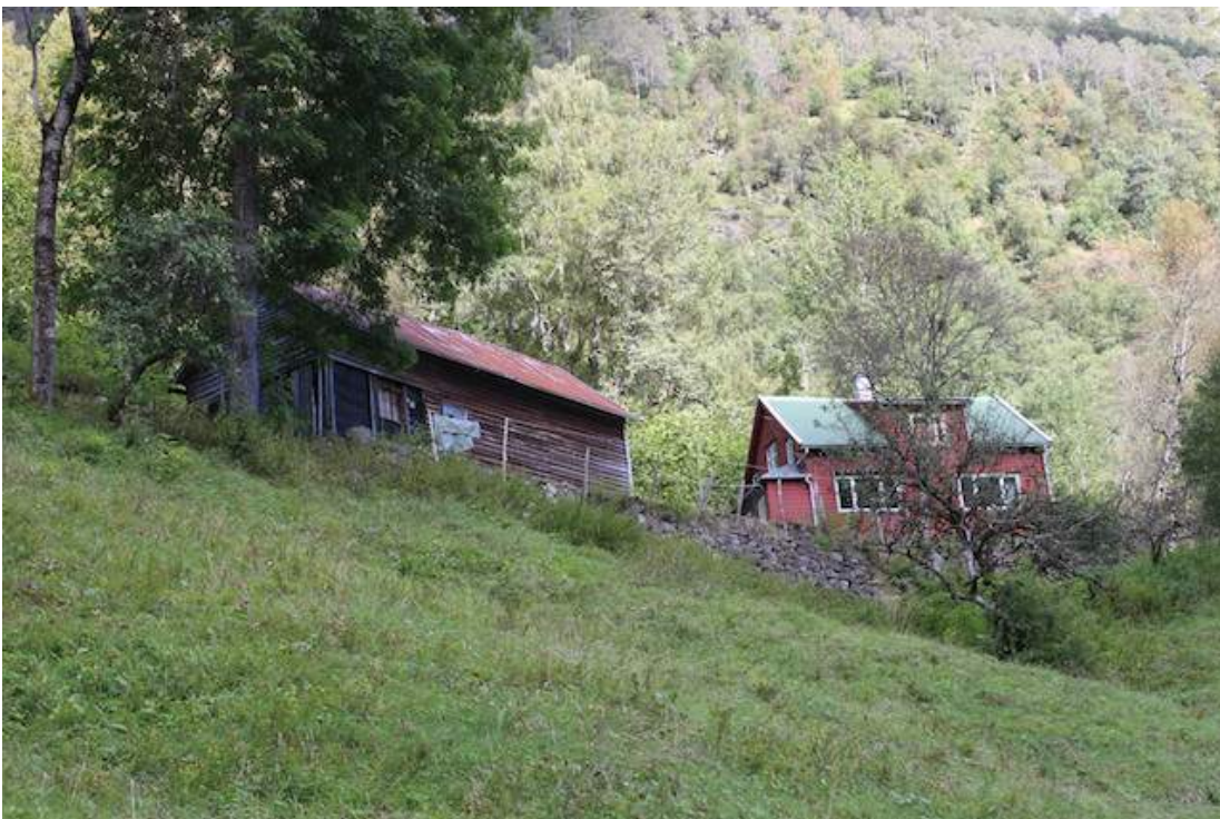
Våningshuset på Drægali er bygt i 1910 og påbygt i 1947. Driftsbygningen vart bygt kring 1920. Bygningane er i rimeleg god stand.
