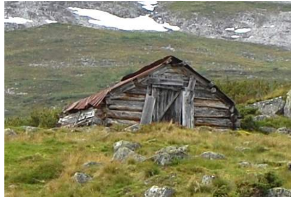
Tømra sel. Fare for stor utskifting av tømmer ved eventuell restaurering.
