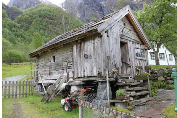
Stabbur på bnr. 58/1. Lafta bygning, bygt før 1850. Taket har tidlegare vore omtekt, men hellekkinga er noko knapp i gavlane, og det kan difor vere fare for lekkasjar.
