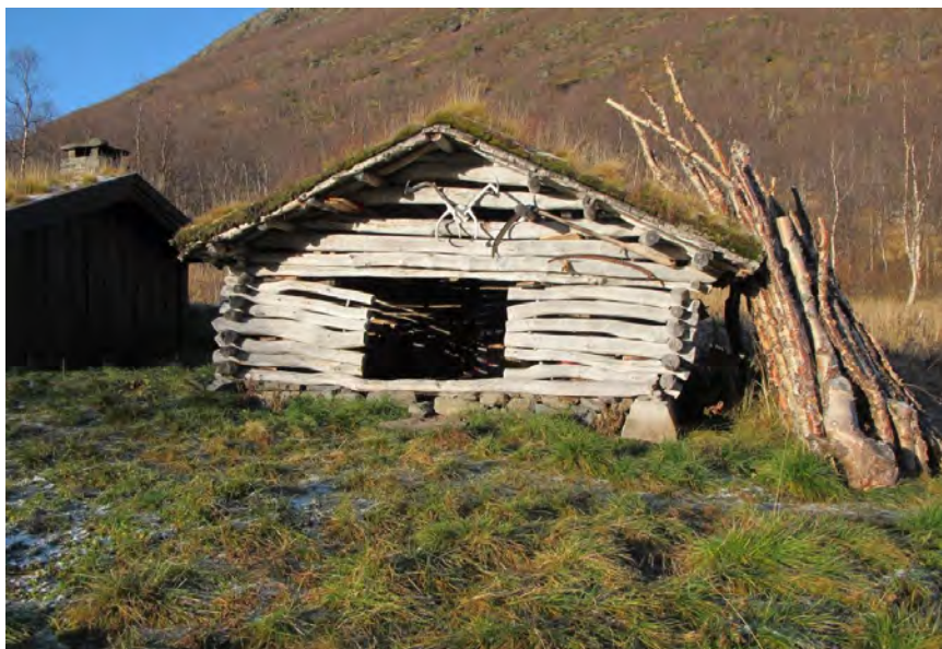
Utløe ved Stormdalsgården er skjev og bør utbedres. Foto Kristian Sivertsen
