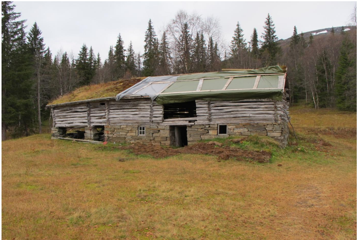
Låven ved Granneset med takskader. Foto: Kristian Sivertsen
