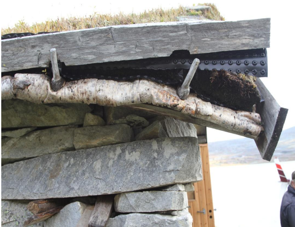
Takskader ved steinstua N Bjøllåvatn. Foto: Kristian Sivertsen
