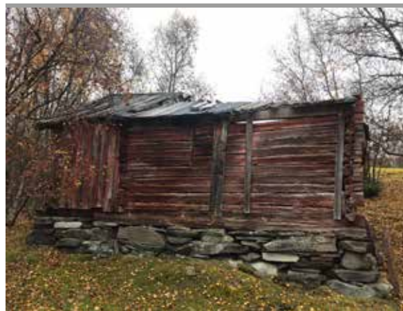
Over: Taket er i ferd med å falle inn i bygningen, og det må settes iverk strakstiltak om bygningen skal berges. Foto: NTRM.
