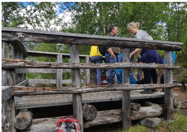
Figur 1: Bilde viser noe av slitasjen på eksisterende plattform
