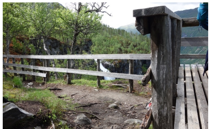
Figur 2: Slitasje på eksisterende plattform og gjerde
