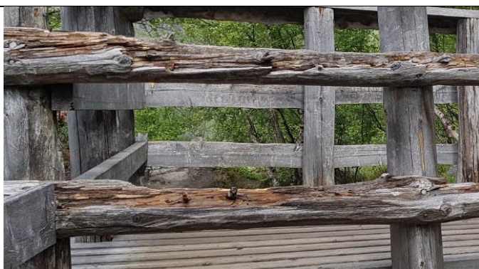
Treverk i gjerde og rekkverket til plattformen er i ferd med å rotne. Det hastar med utbetring.
