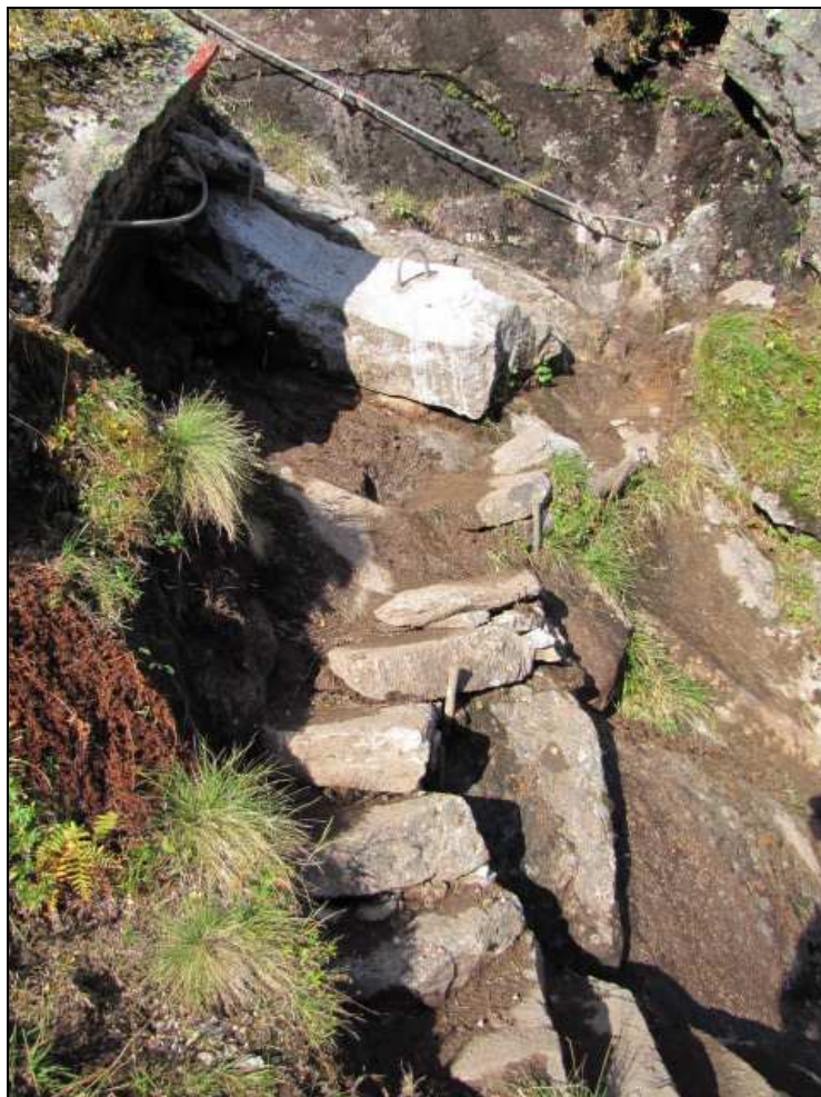
Nedre smale S-sving. Løkker og løpande wire.
