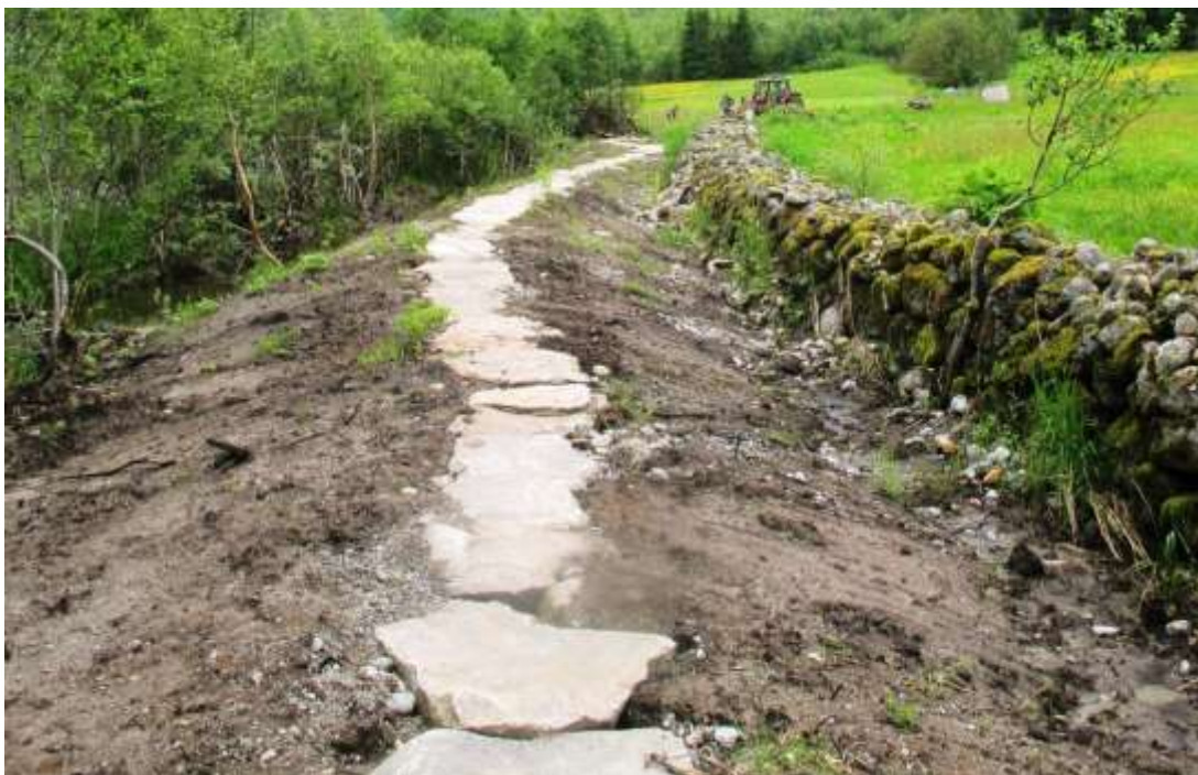
Utbetringsarbeid på stien ved Bergset. Stien er heva og det er lagt ned steinheller til å gå på.
