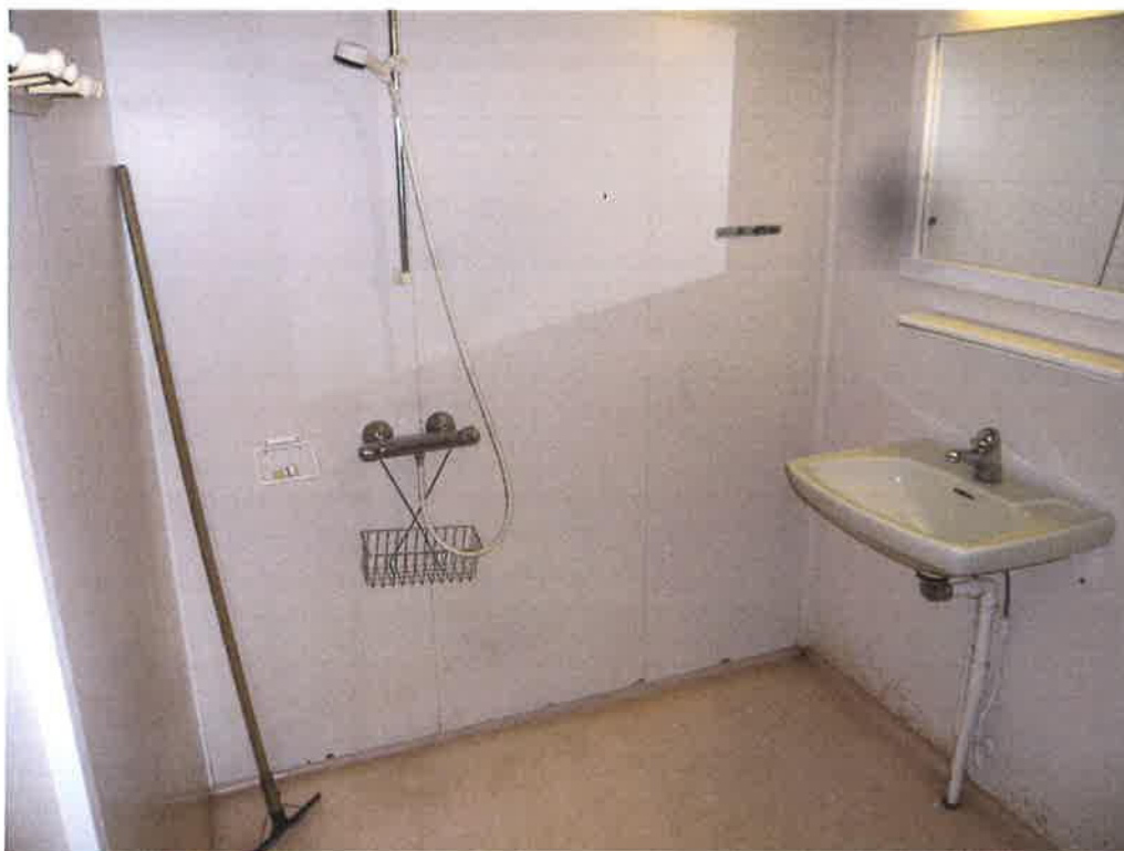
Baderom med veggdusj med behov for oppgradering.
