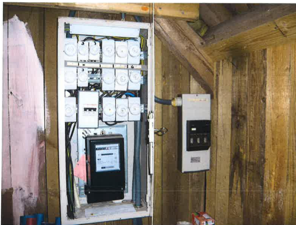
Sikringsskap i 2.etg. med skrusikringer. Hovedinntaket er plassert her.
