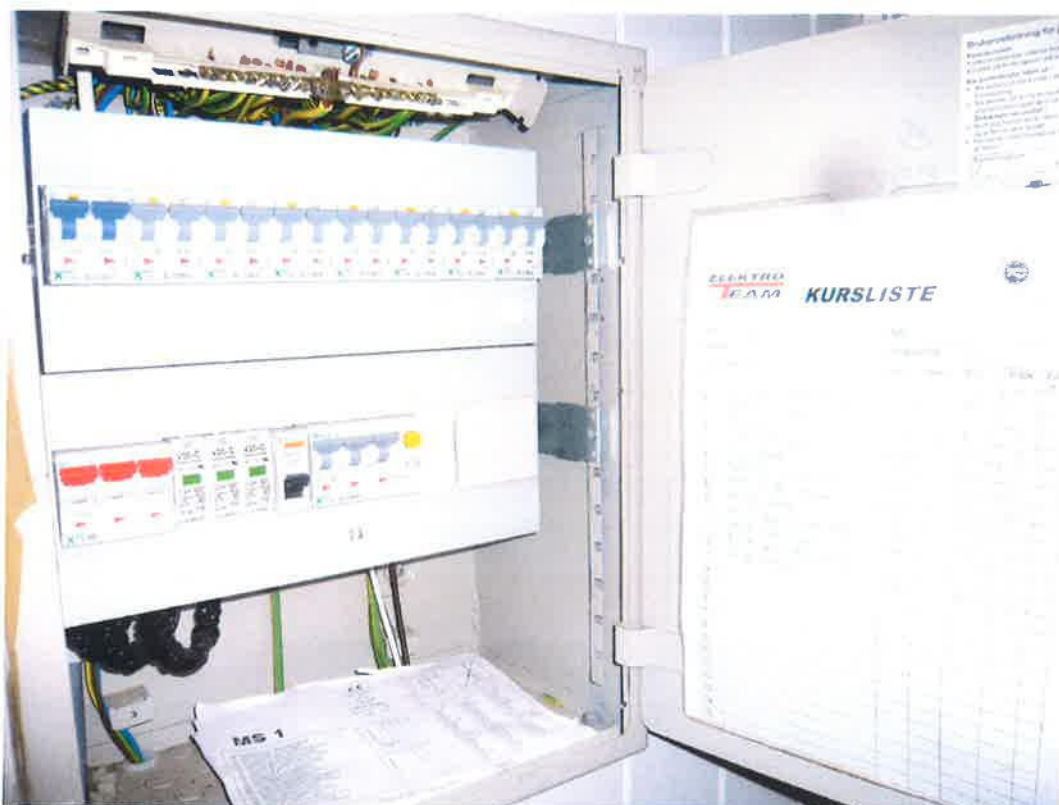
Sikringsskap er med automatsikringer.
