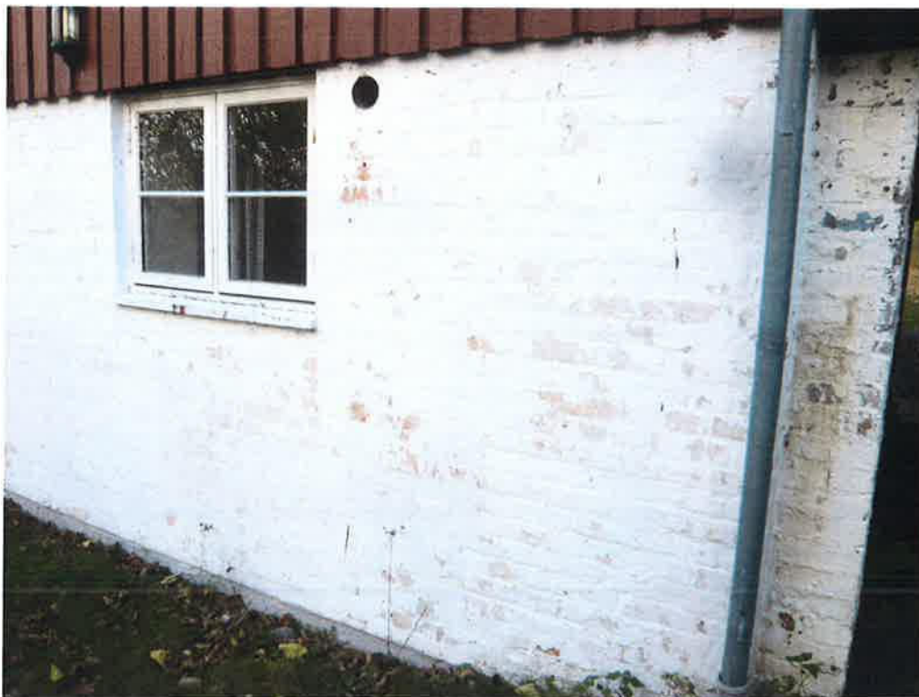
Grunnmur med behov for vedlikehold.
