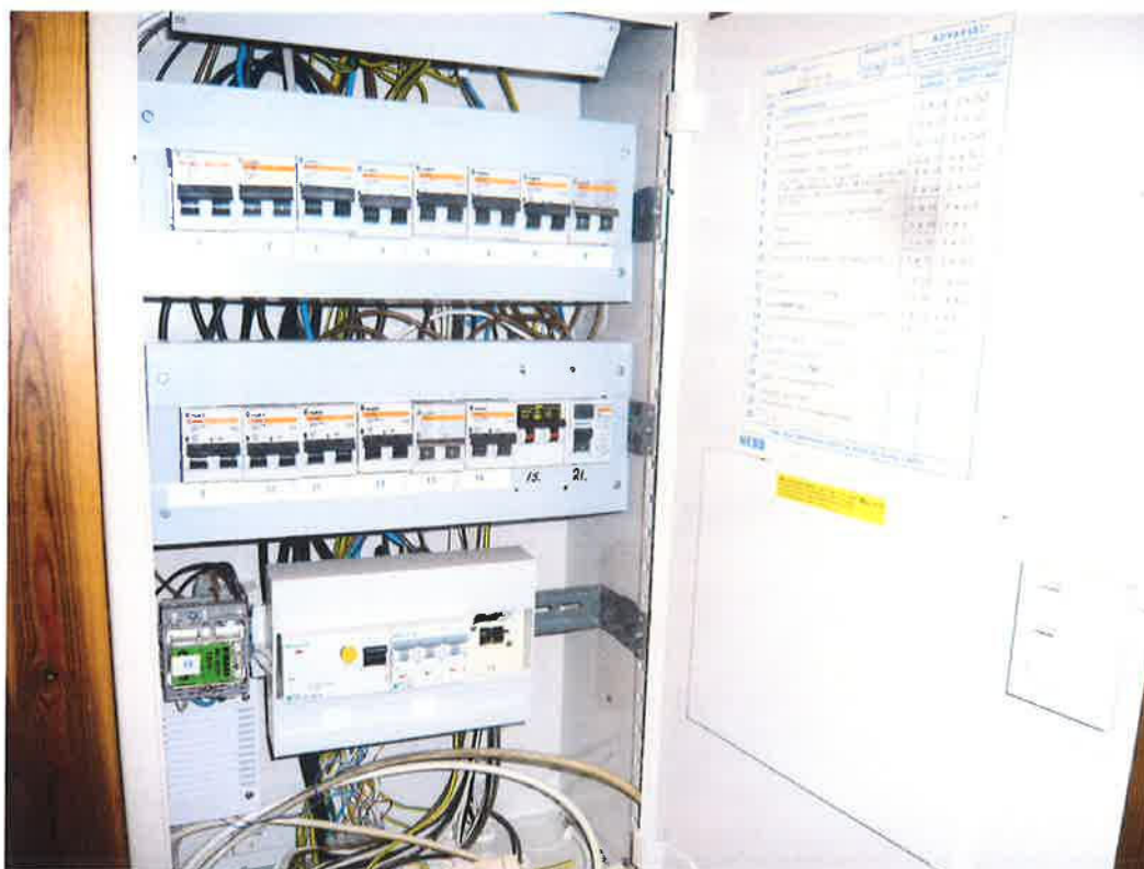
Sikringsskap med automatsikringer.
