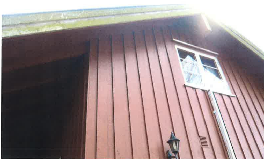
Vindskebord trenger vedlikehold. Det er montert brannstige.
