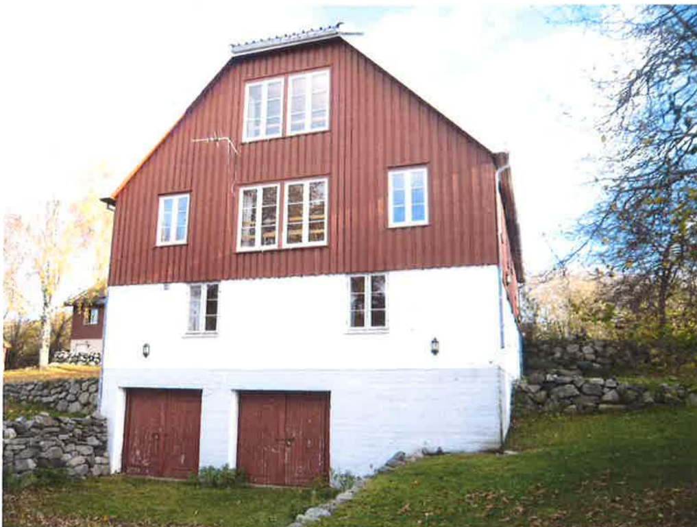
Porter til kjellerrom, trenger vedlikehold.
