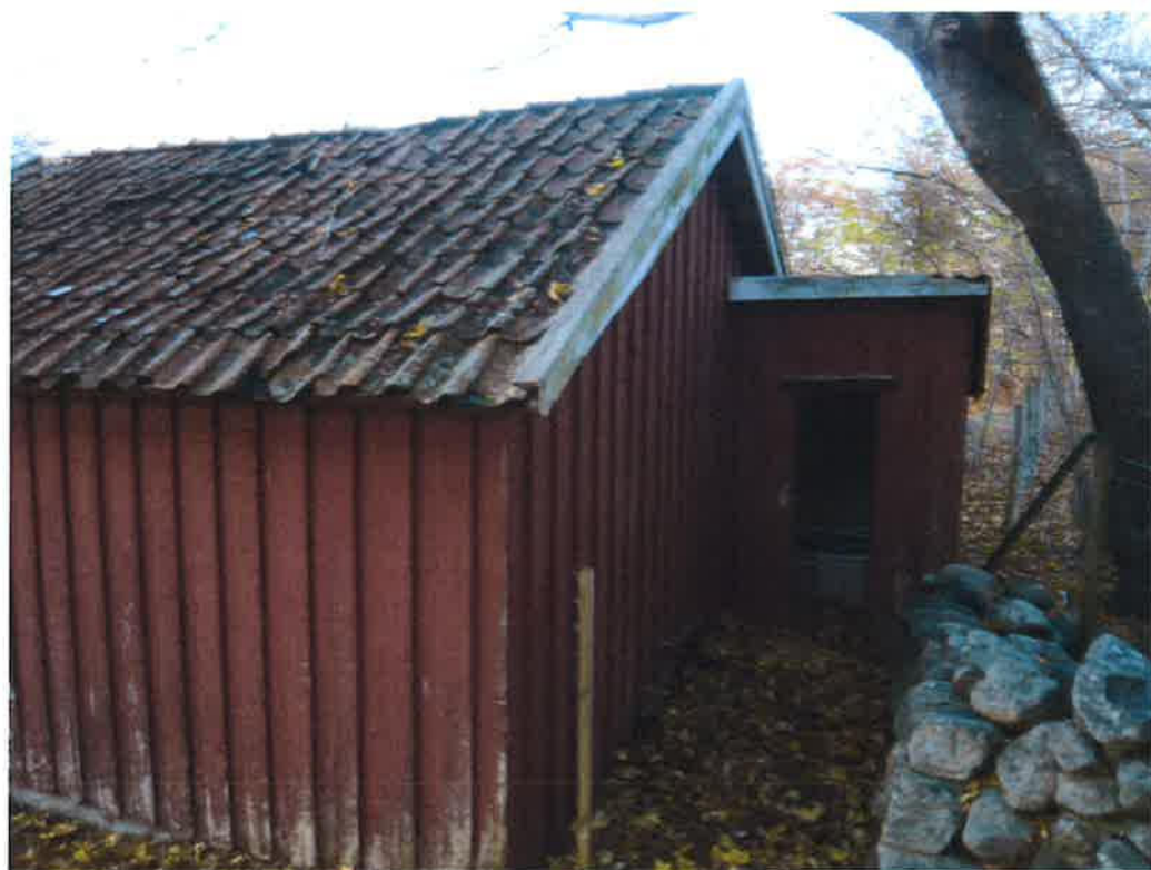
Gammel takstein med behov for utskifting.
