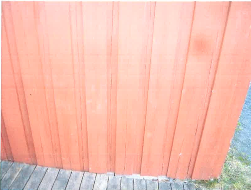
Utvendig kledning har sprekkdannelser, med behov for vedlikehold.
