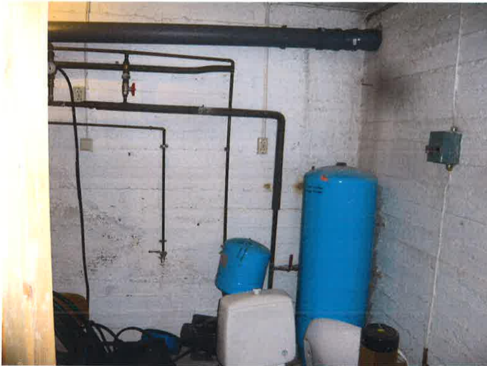
Kjellerrom med litt avflassing i maling.
