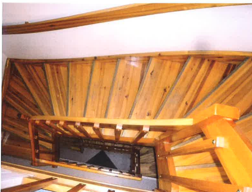
Trapp til 2.etg. har noe bruksslitasje.
