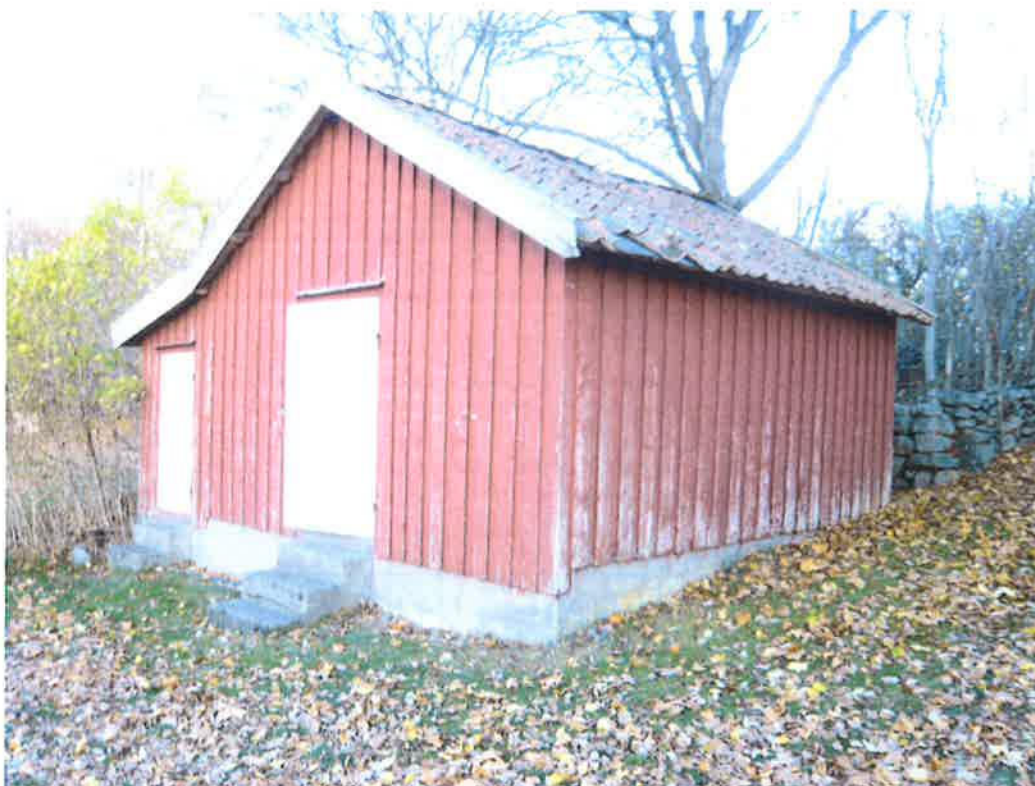
Uthus er i dårlig stand.
