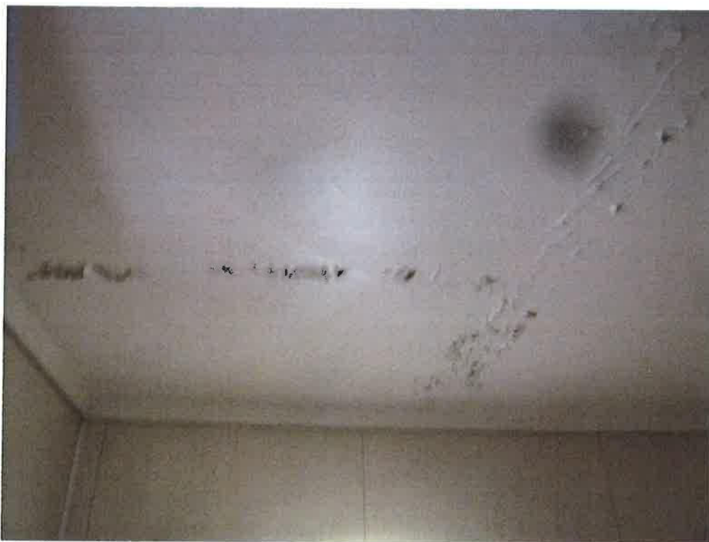
Himling på bad 2 har synlig tegn på fuktighet.
