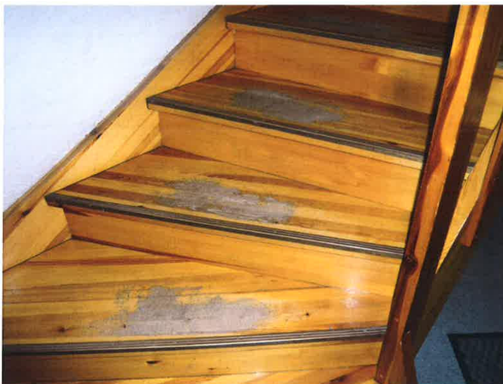
Trapp til 1.etg. har endel bruksslitasje.
