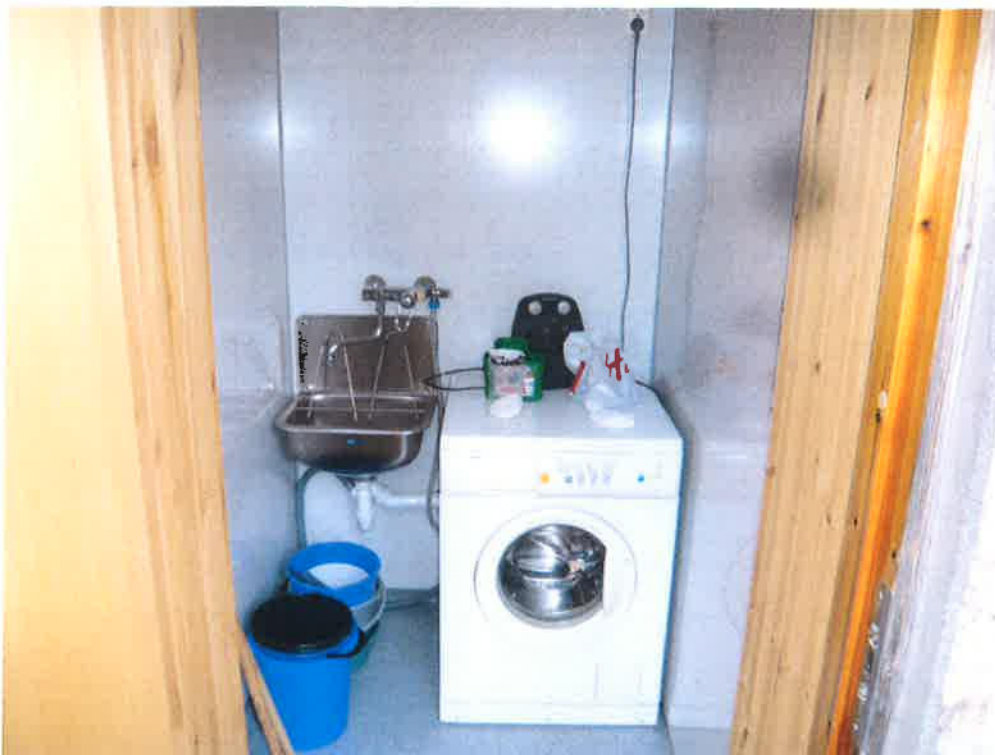
Vaskerom med inngang utenfra, har noe lukt. Bør kontrolleres nærmere.
