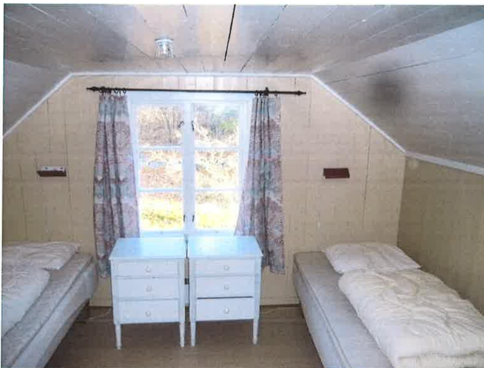
Innredd rom i 2.etg. har ikke målbart areal – under 190 cm.
