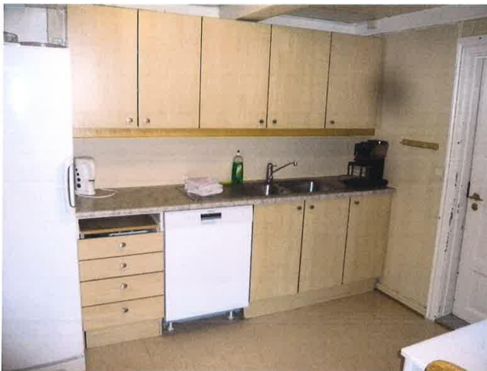
Kjøkkenen i 1.etg. har noe slitt innredning.
