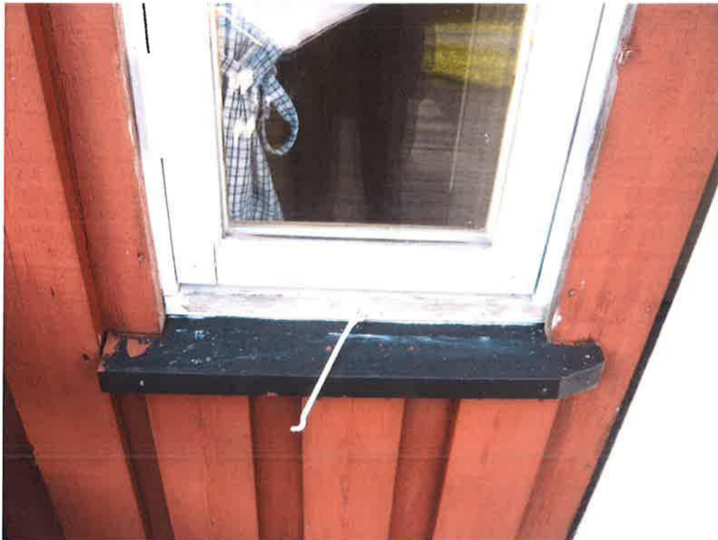
En del vinduer trenger vedlikehold.
