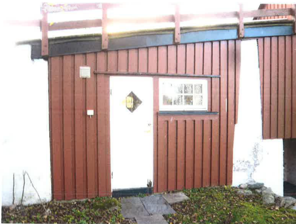
Dør til rom under låvebru, må skiftes pga. råte. Muren trenger maling.
