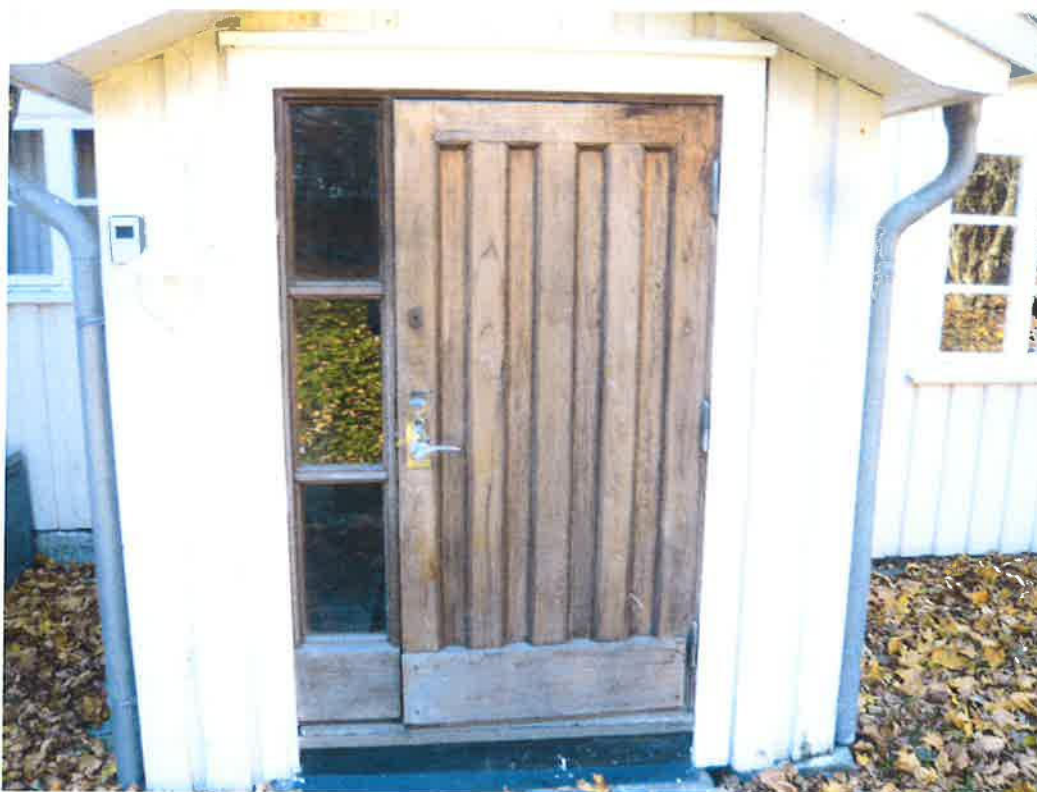
Ytterdør er av eldre årgang, har sige og er slitt.
