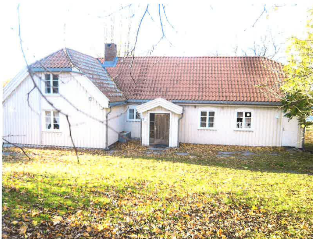
Hovedhus. Deler av taket har eldre takstein. Sidedør er gammel og tetter dårlig.
