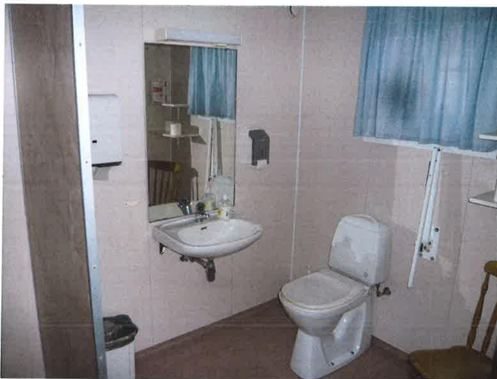
Bad 2 i u.etg. er fra tidlig 1980-tallet, og har fuktproblemer i vegger og himling.
