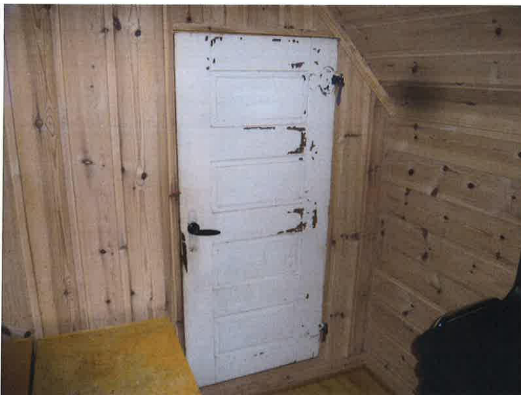
Dør til liten bod er i dårlig stand.
