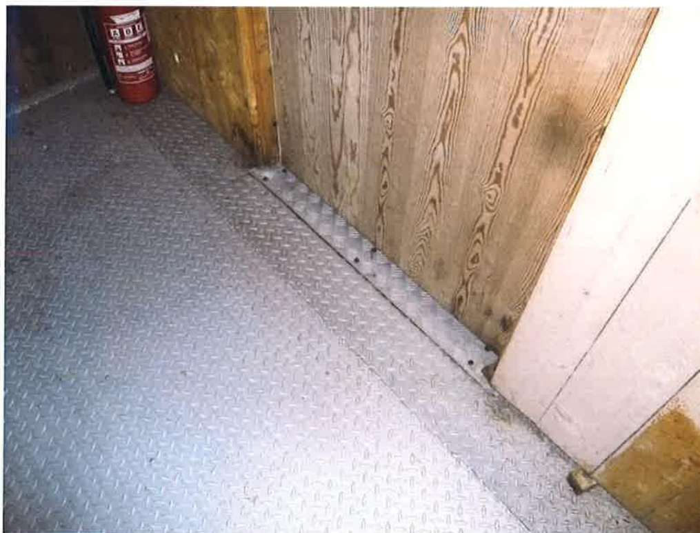
Ytterdøren er ikke luft-tett nederst.
