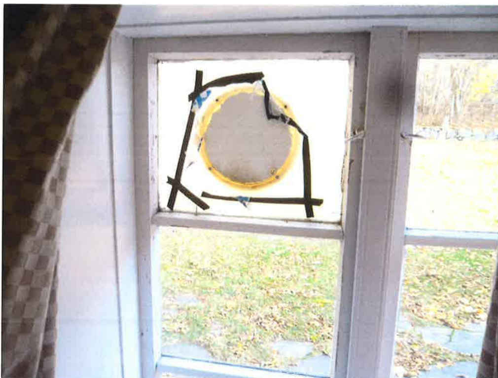
Ventilasjonshull i vindu på bad. Ventilasjon må oppgraderes.
