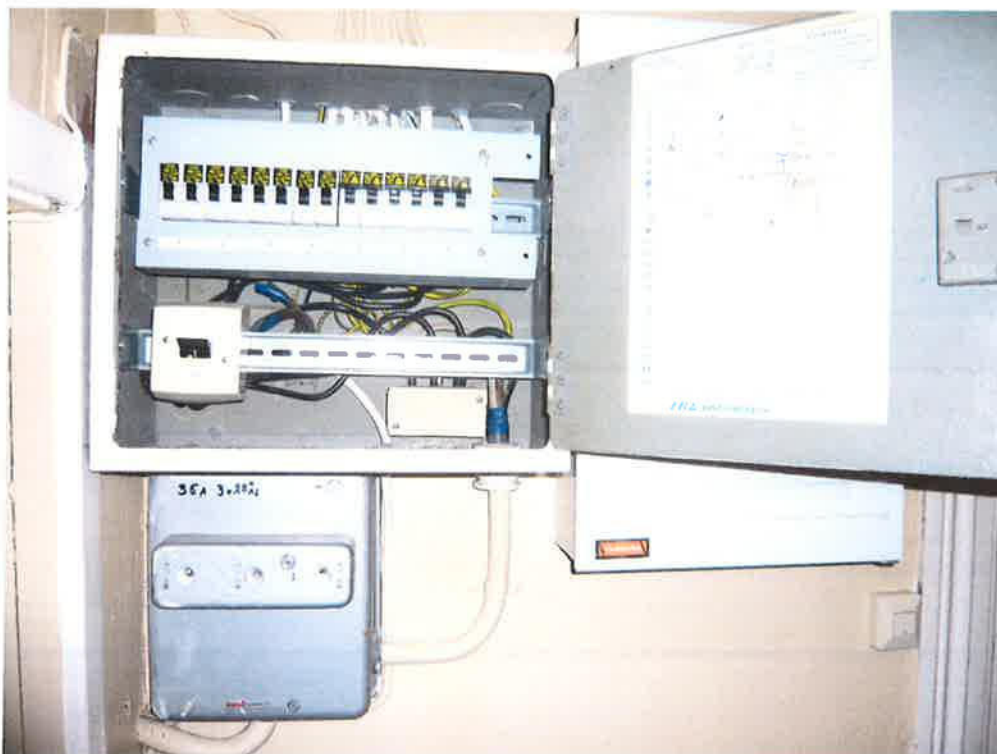
Sikringsskap med automatsikringer.
