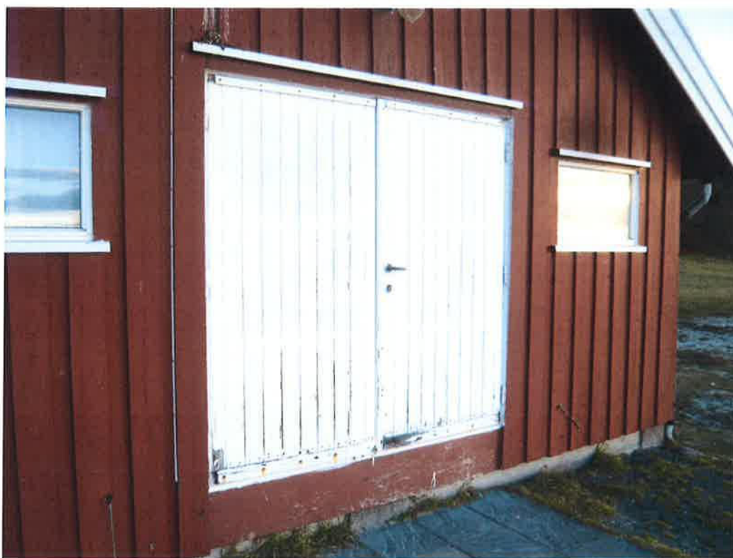
Tofløyet dør mot sjøen er i dårlig stand.
