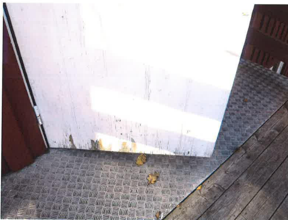
Dør inn fra låvebru, trenger vedlikehold.
