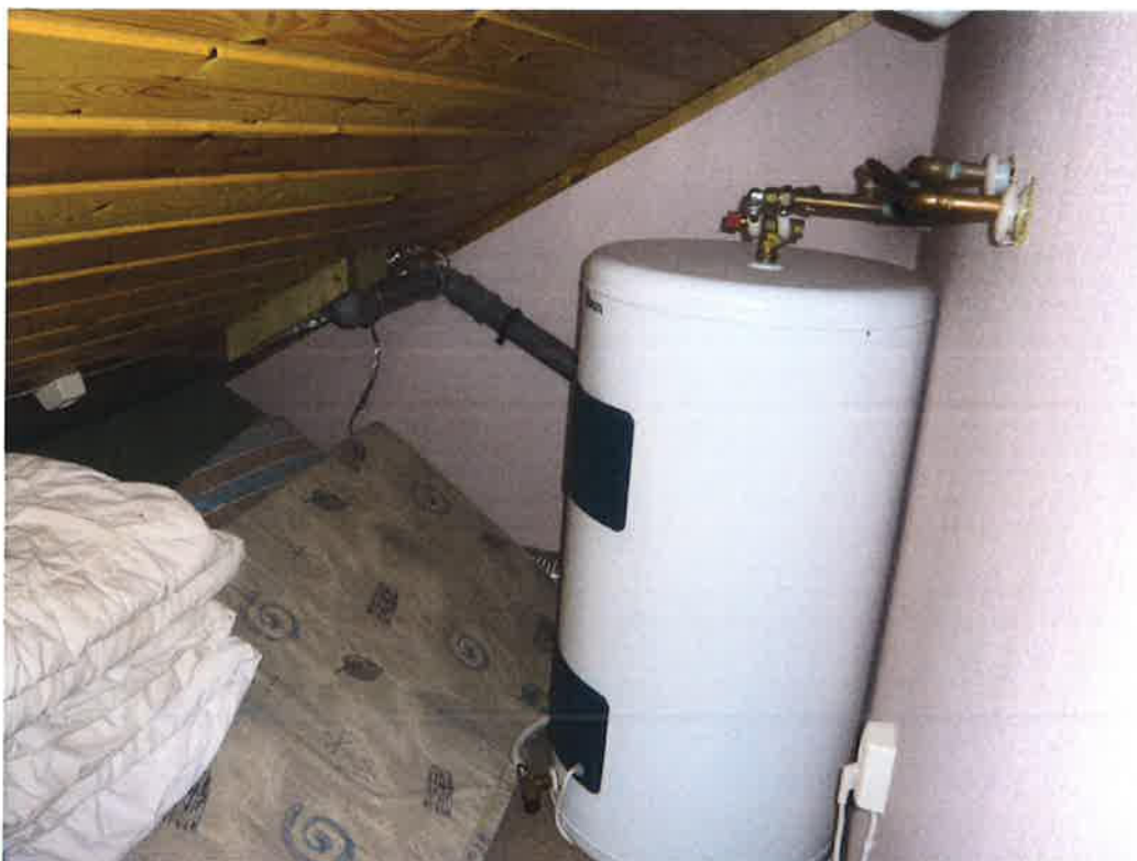
VV-bereder er installert på kott i 2.etg.
