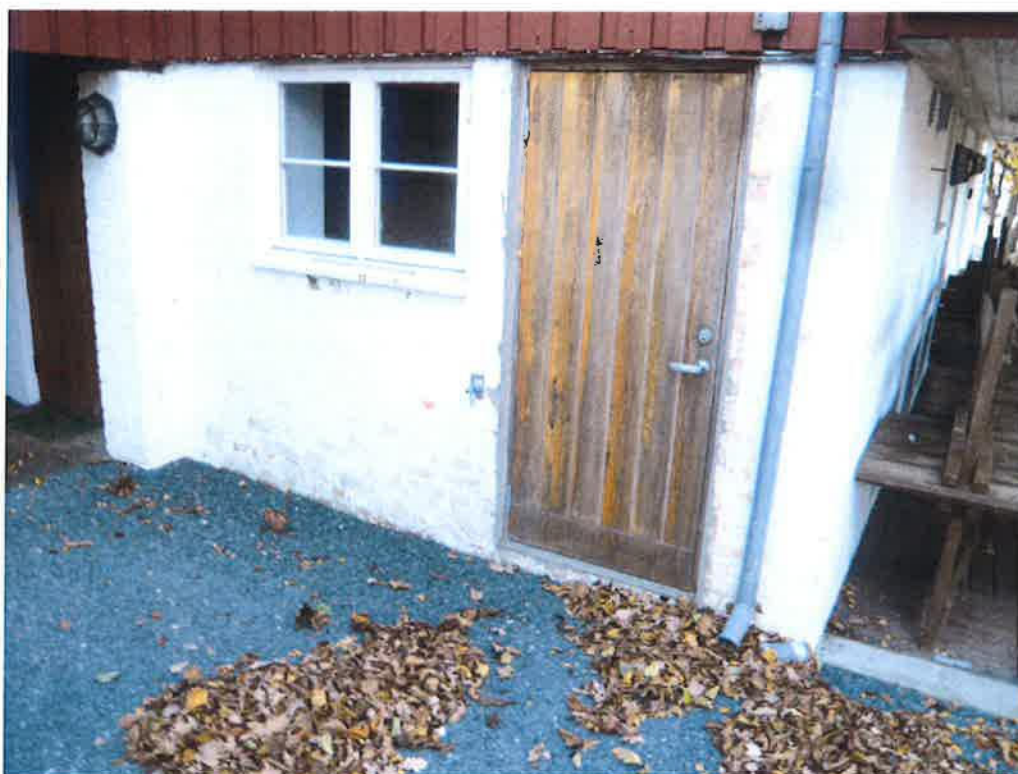
Dør til utvendig vaskerom, trenger vedlikehold.
