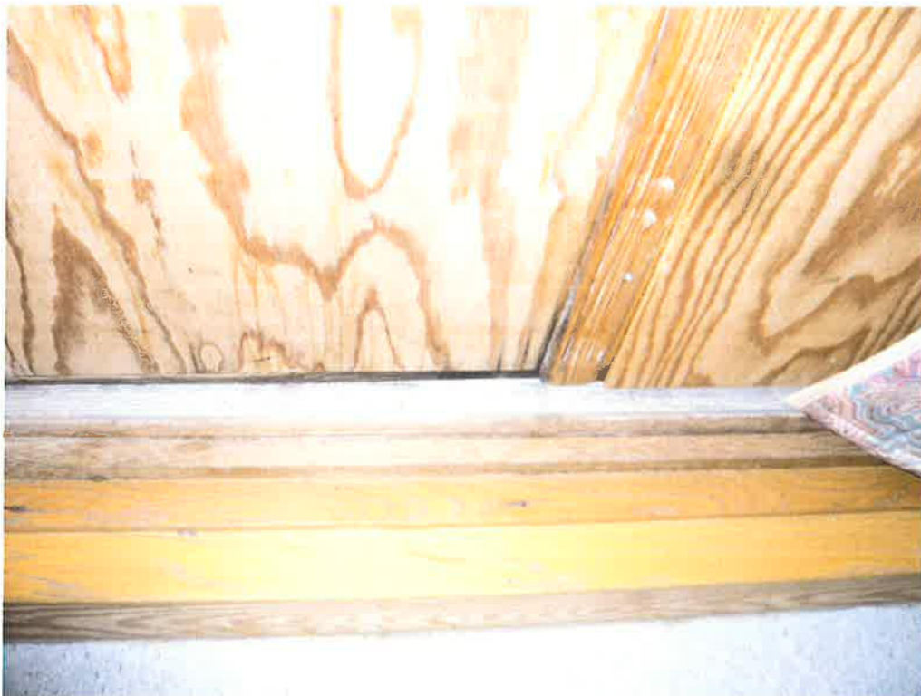
Tofløyet dør tetter dårlig – sett innenfra.
