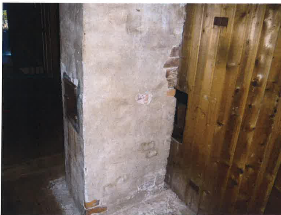
Pipe med feieluke i gang i 2.etg. Med behov for oppgradering.
