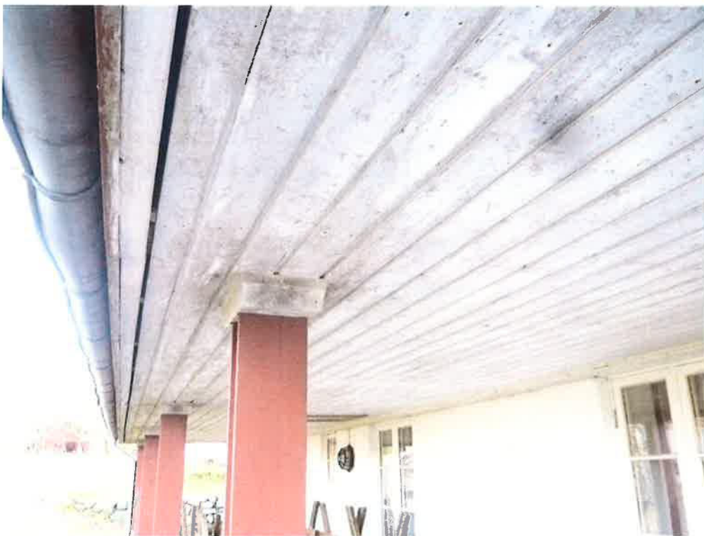
Himling og takrenne ved dør inn i u.etg., har behov for vedlikehold/oppgradering.
