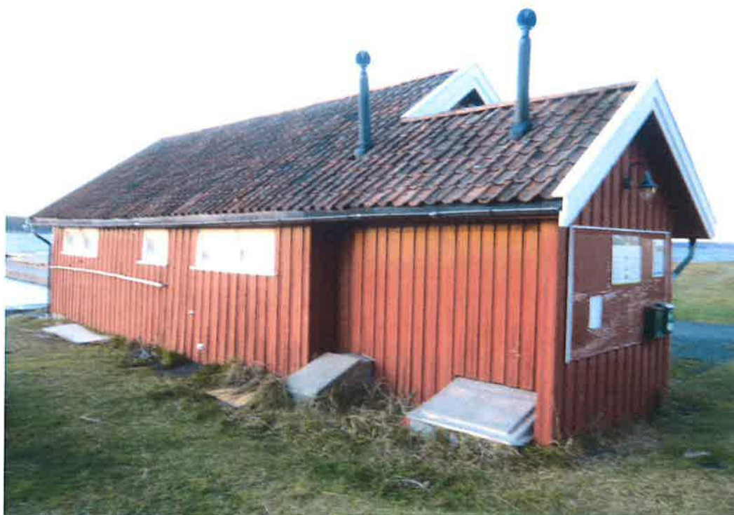
Taktekket og takrenner er av eldre årgang. Synlig skjevhet ved gesimsen.
