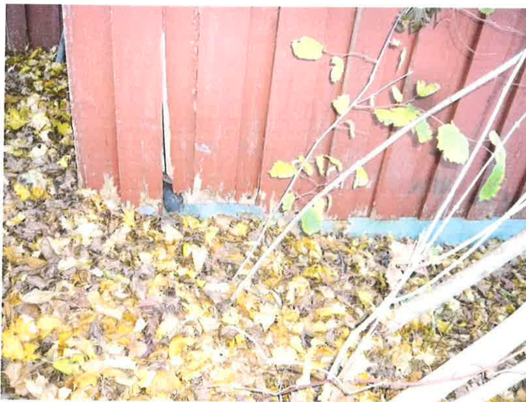
Utvendig kledning har råte og må påregnes utskiftet.
