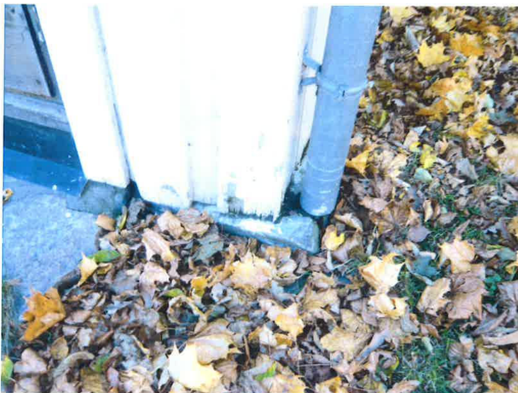
Utvendig kledning har noe råte.
