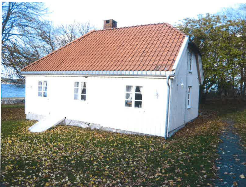
Vinduene er gamle, og de fleste er med enkelt glass.
