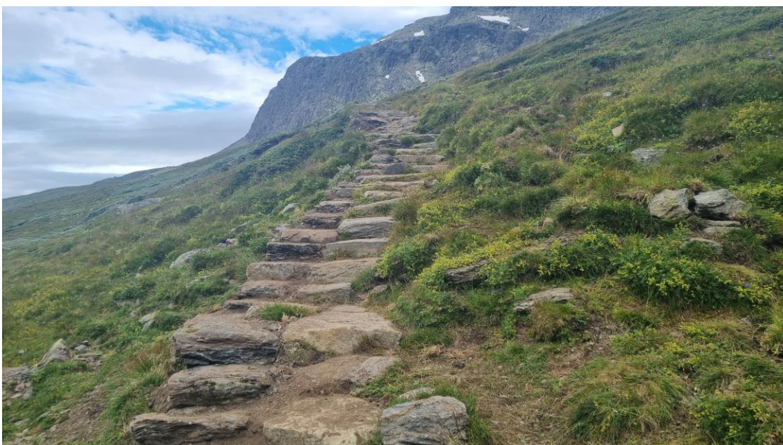
Etter utbedring. Legg merke til at stien har fått dobbel bredde og at "villstien" oppe til høyre er revegetert. Foto: Petter Braaten
