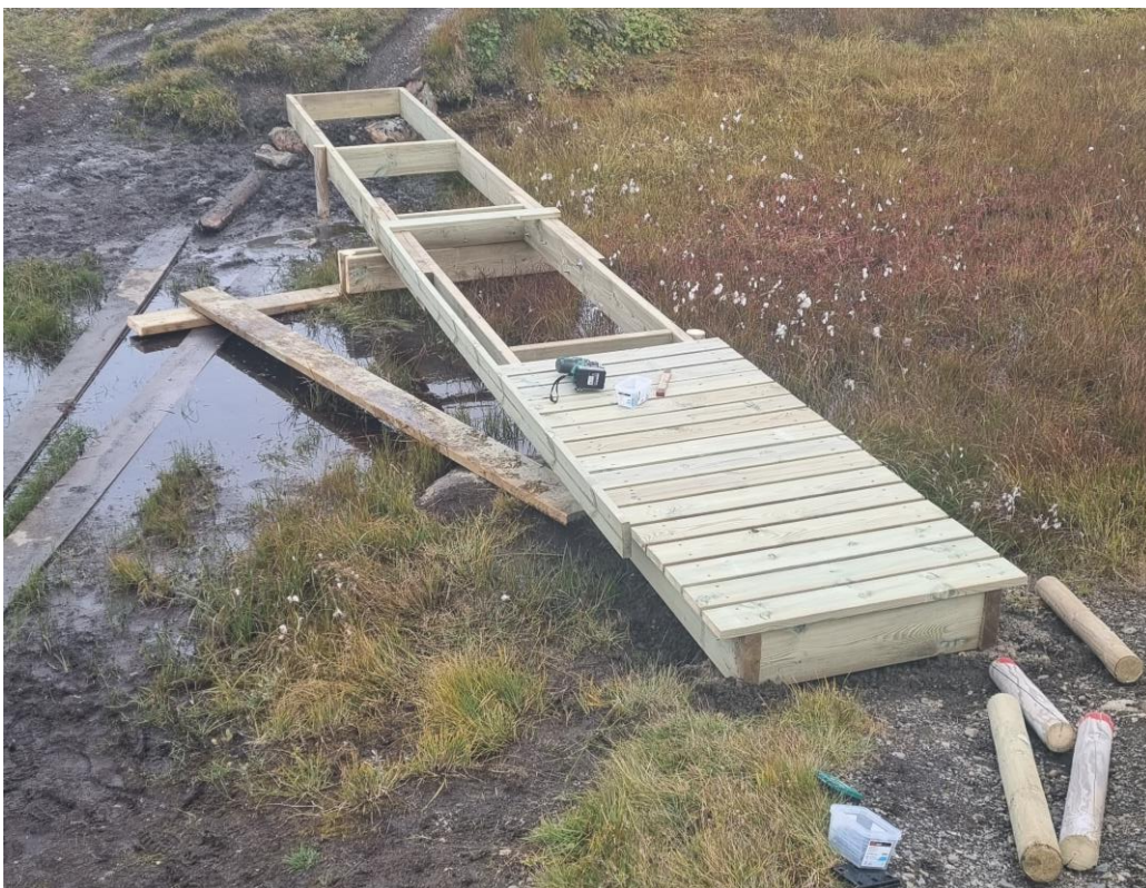
Brua begynner å ta form. Det er satt på avstivninger i ramma samt at det er plugga ned noen flere fester i bakken. Dekket oppå brua begynner å ta form. Foto: Petter Braaten
