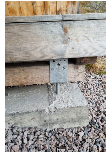
FOTO AV DETALJ DAGENS SITUASJON; EKSPONERT BETONGFUNDAMENT OG BUNNSVILL MED GALAVNISERT STOLPESKO
