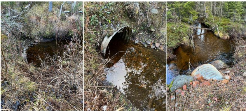
Figur 42. Bilder av utløp fra stikkrenne 1000 mm.
