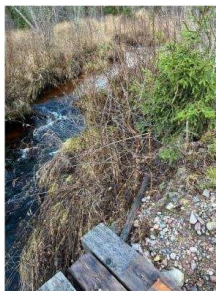
Figur 46. Det var tydelig at vannet hadde gått høyt på vegetasjon ved innløp til brua.
