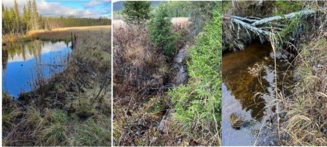
Figur 41. Bilder av vever demming, grøft og innløp til stikkrenne 1000 mm.
