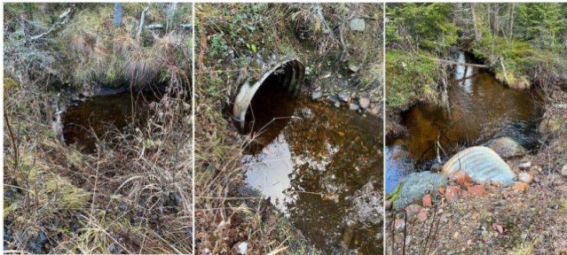
Figur 42. Bilder av utløp fra stikkrenne 1000 mm.
