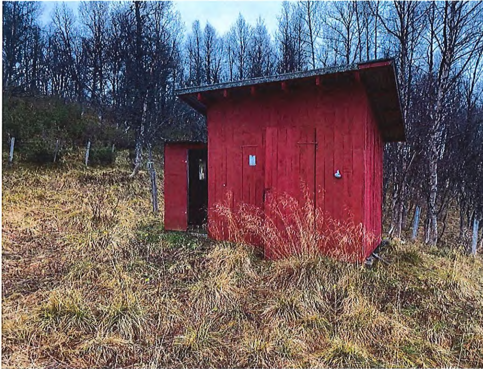
Bildet er tatt fra setertunet mot sør. Vedskjulet er i reisverk med bølgeblikkta. Utedoen er i sponplater med bølgeblikkta. Utedoen er i dårlig forfatning.
