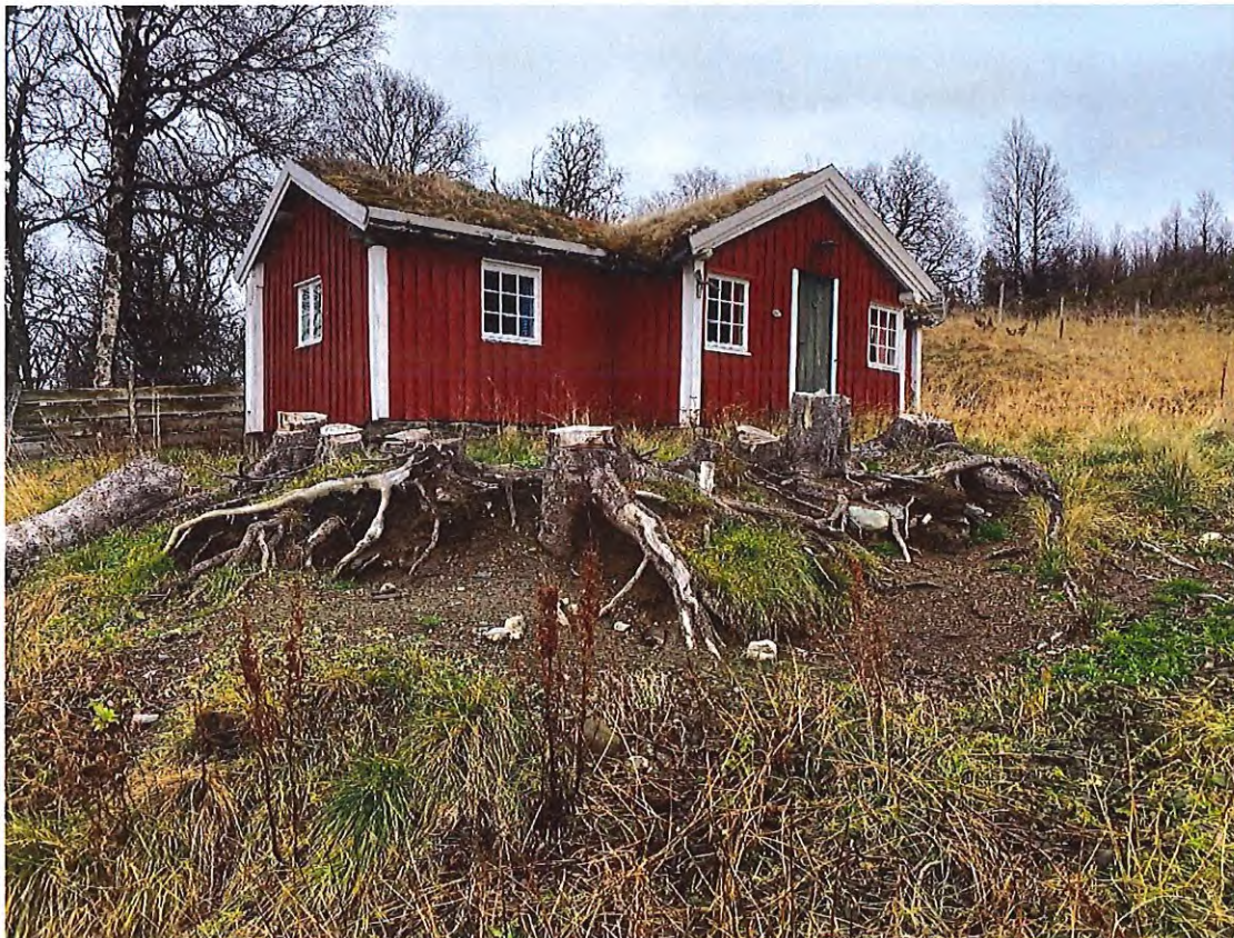
Bildet er tatt fra nedsiden av setertunet mot øst. Seterhuset er utvendig panelt. De to sidebygningene mot øst og vest er tømmerkasser. Midtdelen er reisverk. Taket er av torv og i dårlig forfatning. Innvendig er det mye fukt og råte i gulv.
