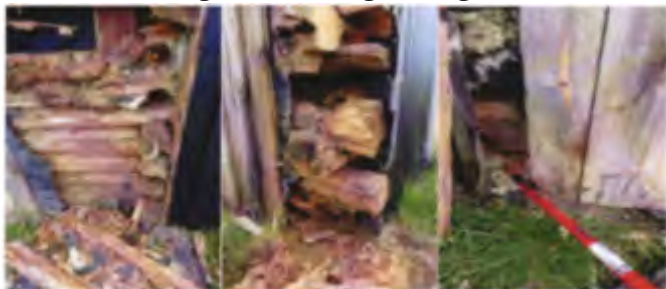
Billedokumentasjon på buas tilstand.
