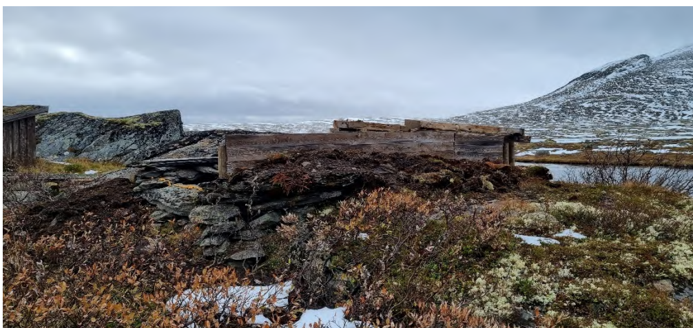
Figur 3: Dagens status på naust, tilknyttet bu-tomt nr. 4. Takkonstruksjon er tatt ned og fraktet ut etter at taket kollapset.
