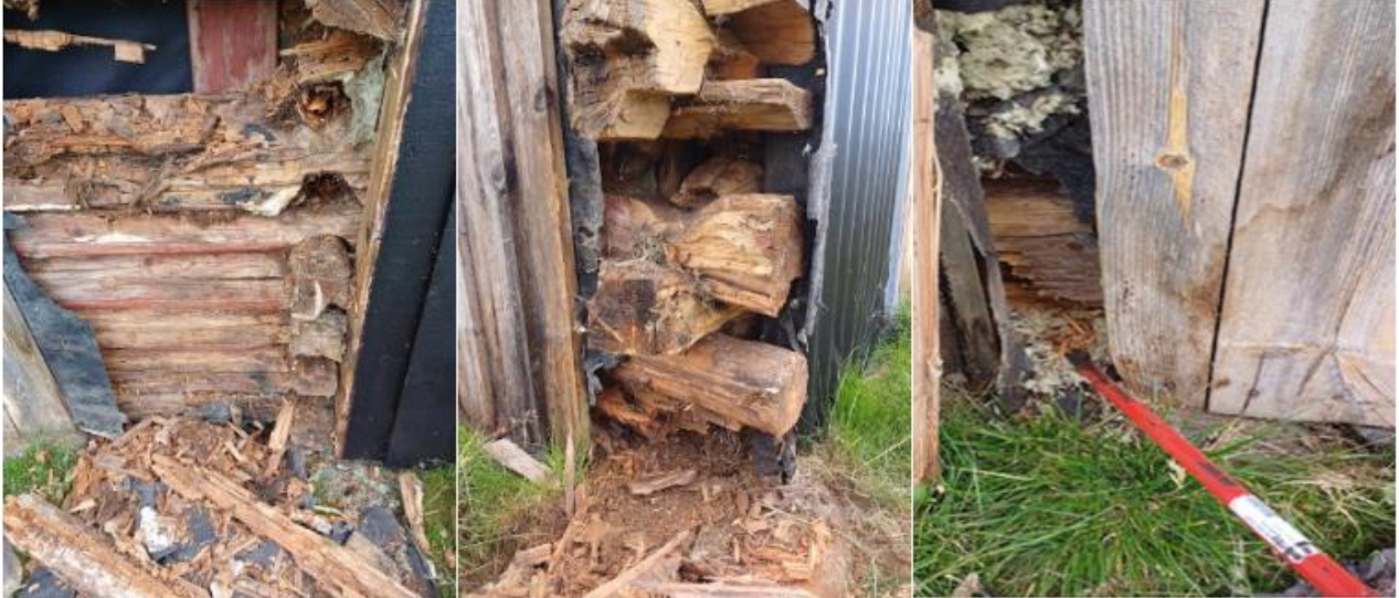
Billedokumentasjon på buas tilstand.
