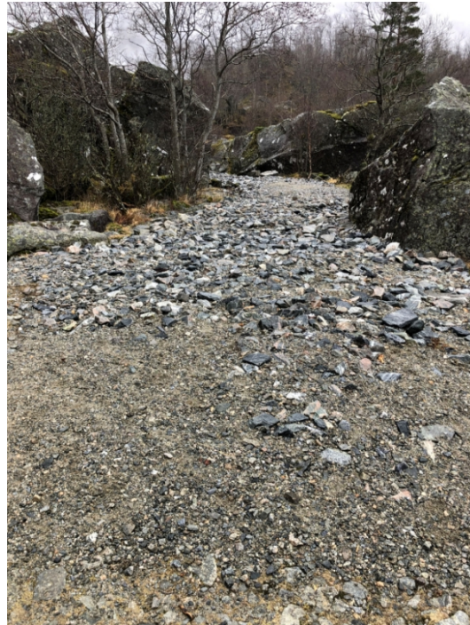
Ved vatnet er det grove massar på deler av vegen som har vorte vaska vekk for fleire år sidan.
